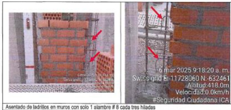
Asentado de ladrillos en muros con solo 1 alambre # 8 cada tres hiladas
