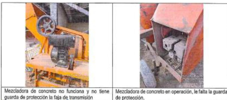
Fotografías N° 08, 09: Equipos mecánicos sin guarda de seguridad
