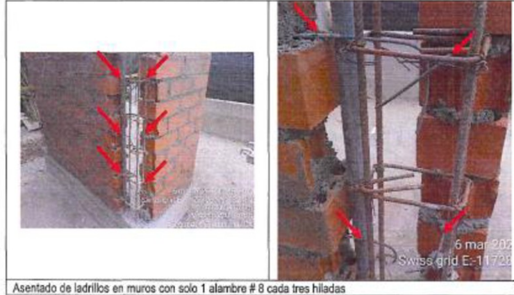
Asentado de ladrillos en muros con solo 1 alambre # 8 cada tres hiladas
