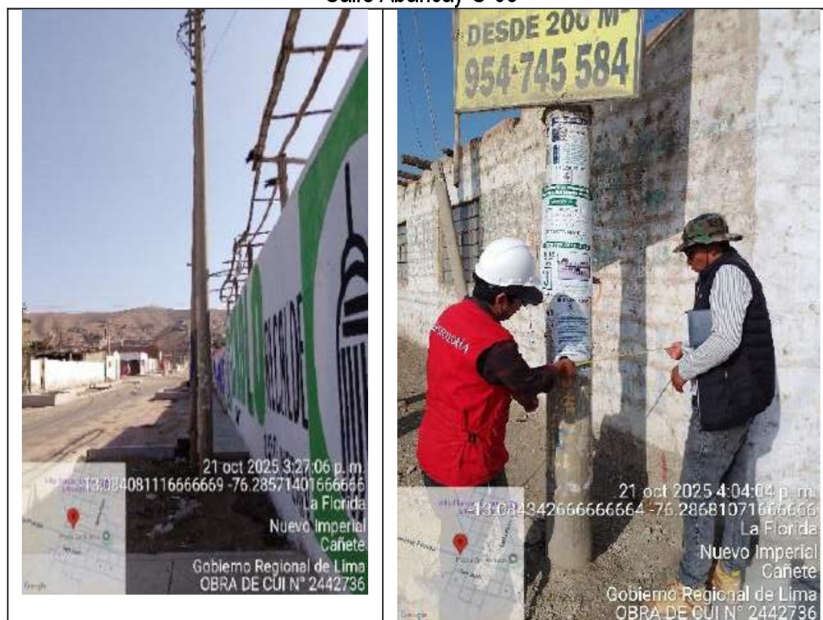
Imágenes n.º 19 y 20 Calle Abancay C-03
