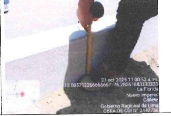
Imagen n.º 8 Que, el piso adoquinado no es uniforme al sardinel sumergido ejecutado.
