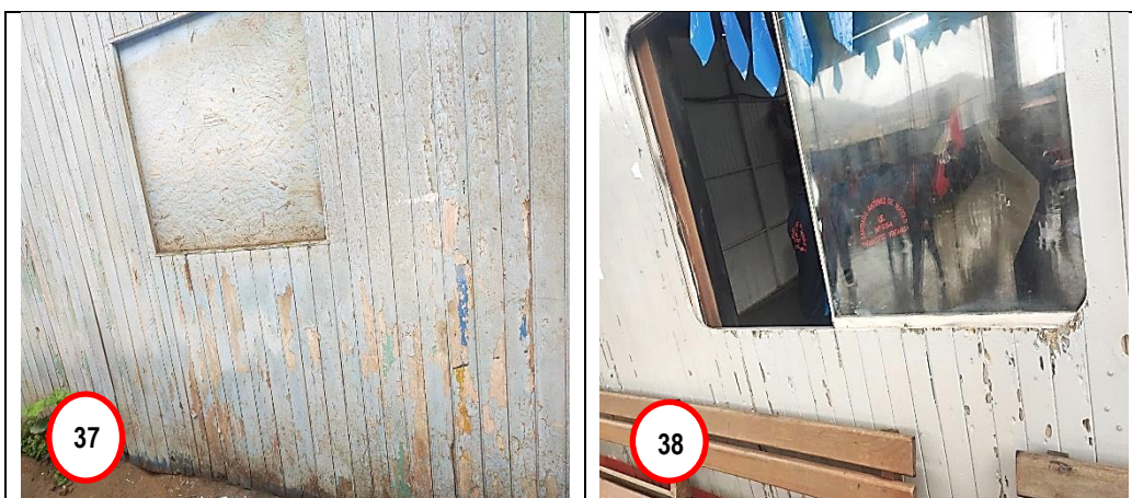
Fotografías n.ºs 37 y 38.- En las tomas fotográficas se muestra que las paredes de las aulas son de material de madera machihembrada que se encuentra apollada y requiere sustitución debido a que presentan filtraciones de agua y deterioro en sus componentes.
