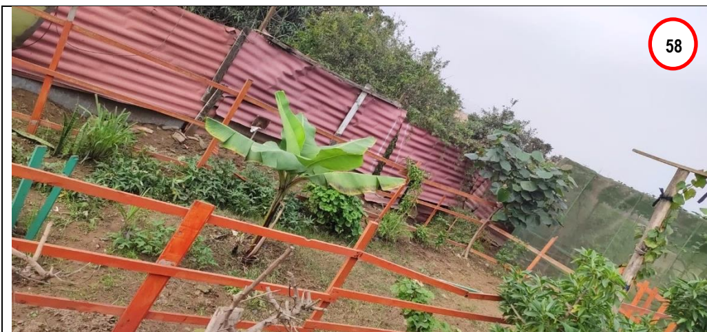
Fotografías n.ºs 57 y 58.- En las tomas fotográficas se observa que hay zonas que no cuentan con cerco perimétrico; asimismo, el cerco perimétrico existente requiere sustitución.
