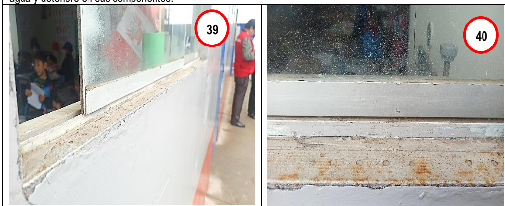
Fotografías n.ºs 39 y 40.- En las tomas fotográficas se constata que algunas ventanas de las aulas requieren mantenimiento como resane y pintado debido a que presentan deterioro en sus componentes.
