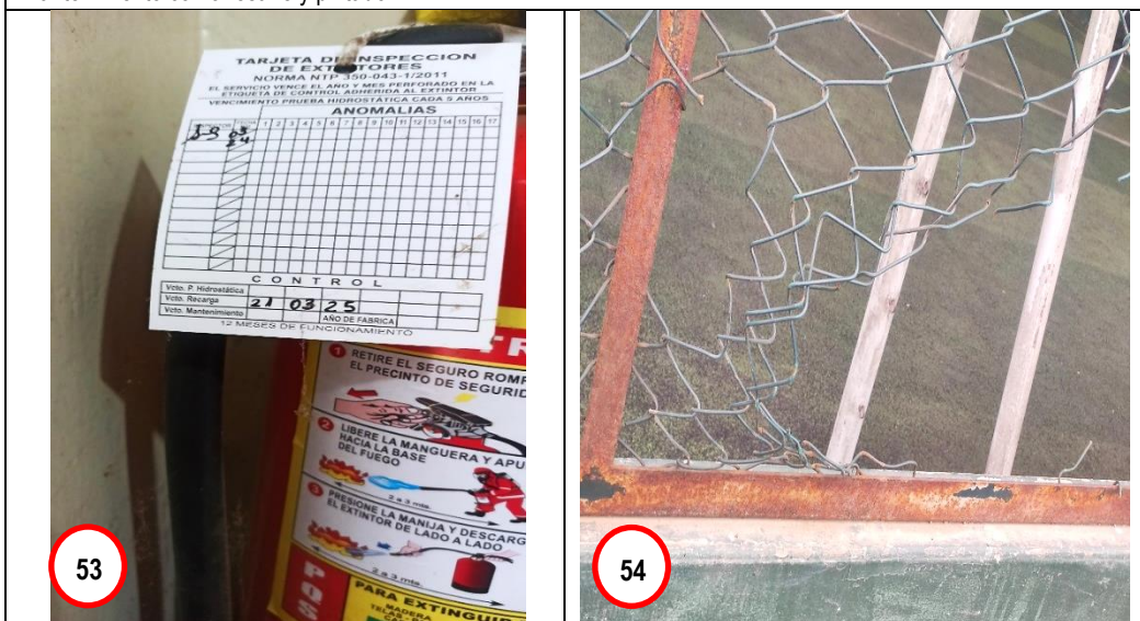
Fotografías n.º 53.- En la toma fotográfica se constata que la I.E cuenta con un (1) extintor que se encuentra vencido cuya fecha de vencimiento expiro el 21/03/2025.
