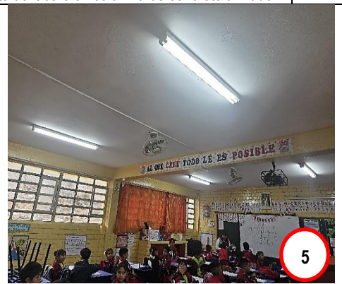
Fotografía n.º 5.- En la toma fotográfica se advierte que al menos un techo del aula requiere mantenimiento como resane y pintado de techos.
