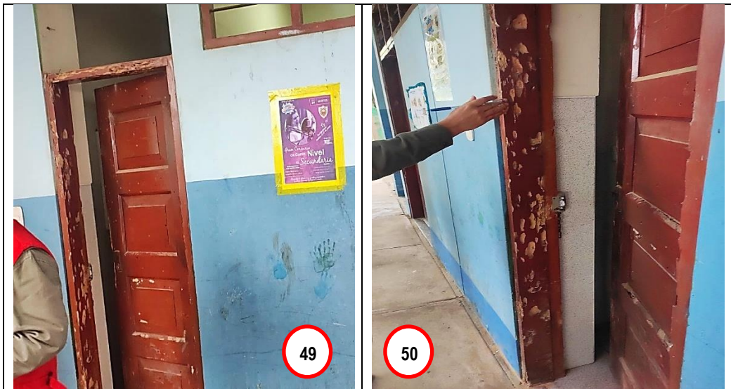
Fotografías n.ºs 49 y 50.- En las tomas fotográficas se muestra la puerta de los servicios higiénicos de varones colindante al aula 2º C primaria y secundaria se encuentra apolillado debido a que presenta deterioro en sus componentes, requiere mantenimiento como resane y pintado
