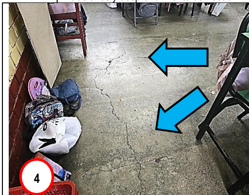
Fotografía n.º 4.- En la toma fotográfica se constata que al menos un piso del aula requiere mantenimiento como resane de pisos.
