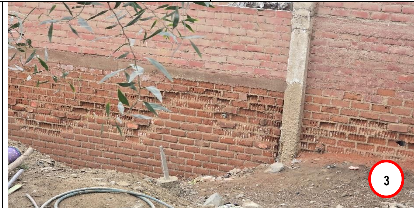
Fotografías n.ºs 1, 2 y 3.- En las tomas fotográficas se observa que el cerco perimétrico requiere sustitución debido a que los muros de ladrillo presentan afectación estructural, filtraciones y desprendimiento del recubrimiento del acero en columna de concreto armado.
