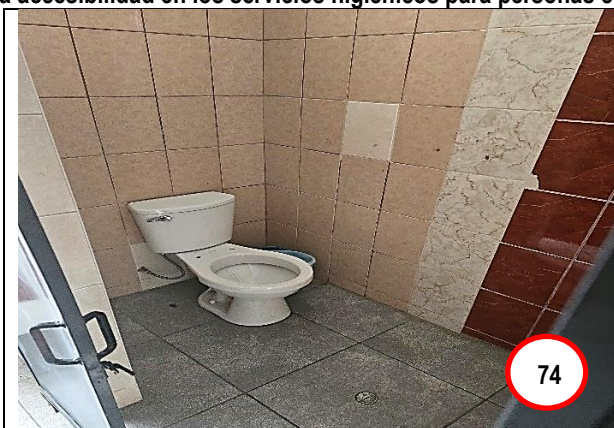
Fotografía n.º 74.- En la toma fotográfica se muestra que en el espacio para inodoro del SS.HH para personas con discapacidad no tiene barras de apoyo tubulares o agarraderas que permita el uso del inodoro.
