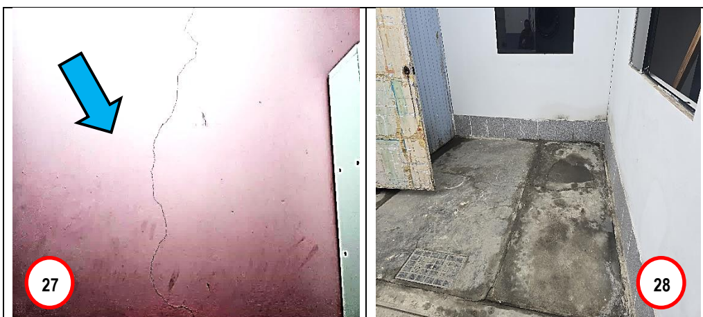
Fotografías n.ºs 27 y 28.- En las tomas fotográficas se muestra que algunos sectores del piso y paredes presentan filtraciones y fisuras.
