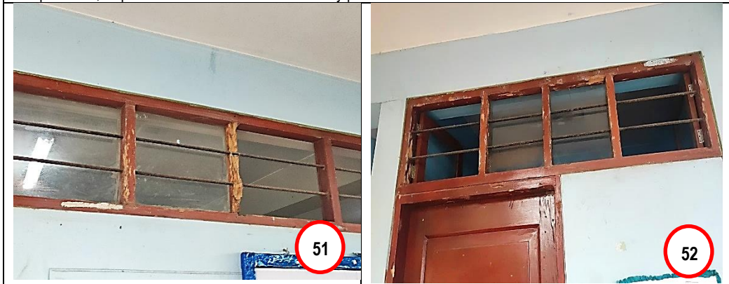
Fotografías n.ºs 51 y 52.- En las tomas fotográficas se observa que algunas ventanas de algunas aulas requieren mantenimiento como resane y pintado.
