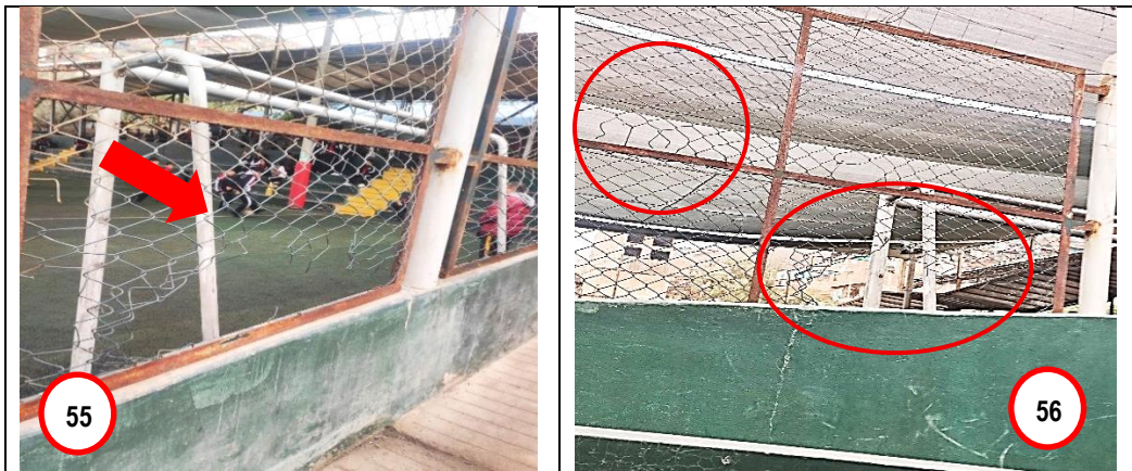
Fotografías n.ºs 55y 56.- En la toma fotográfica se advierte que falta refaccionar el de mallas que protege el campo deportivo con gras sintético, se encuentra roto.
