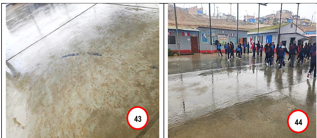
Fotografías n.ºs 43 y 44.- En las tomas fotográficas se muestra que el patio de la I.E cuenta con puntos de reunión o zonas seguras para casos de desastres naturales, sin embargo, los puntos de reunión no se encuentran debidamente señalizados.
