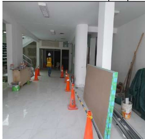
Acondicionamiento no concluido en primer piso
