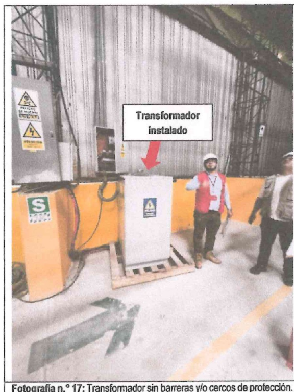
Fotografía n.º 17: Transformador sin barreras y/o cercos de protección.
