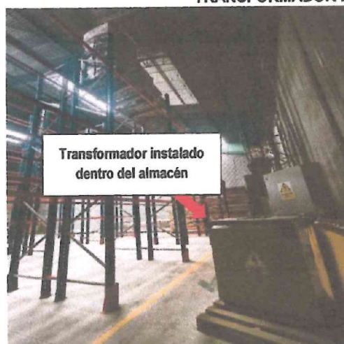
Fotografía n.º 13: Transformador reduce ancho útil.
