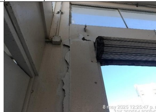
Fotografía n.º 36: producto de los choques a la puerta de embarque.
