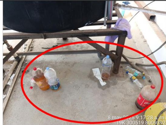
Fotografía n.º 2: Residuos sólidos encontrados en la Sala de compresoras de cadena de frío del DPA Morro Sama
