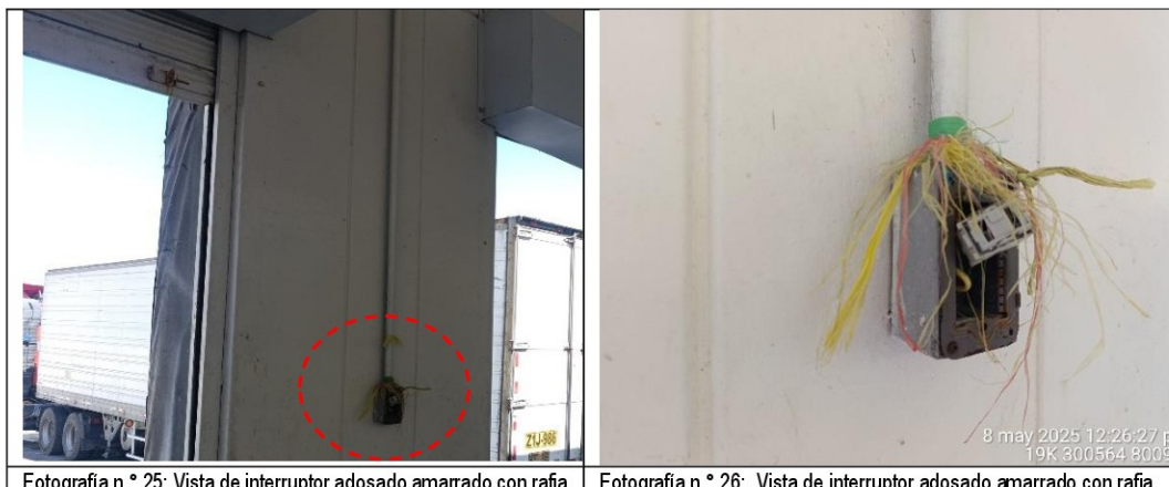
Fotografía n.° 25: Vista de interruptor adosado amarrado con rafia
