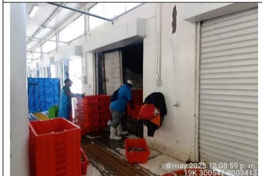
Fotografía n.º 35: Vista desde el interior de puerta de embarque, se observa rajadura y desprendimiento de concreto producto de los choques a la puerta de embarque.
