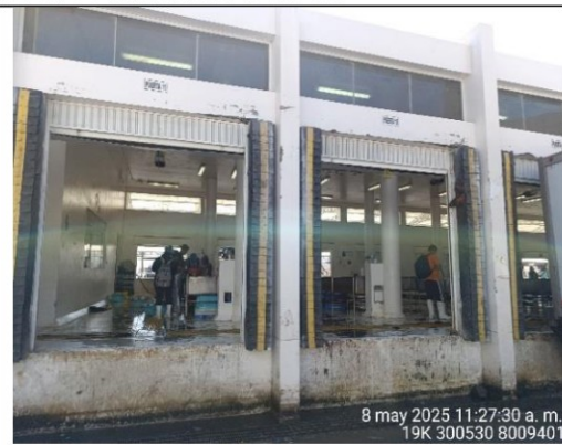
Fotografía n.º 32: Vista de puertas de embarque donde se observa el marco de jebe colocado al costado de puerta para bajar el impacto de choque.
