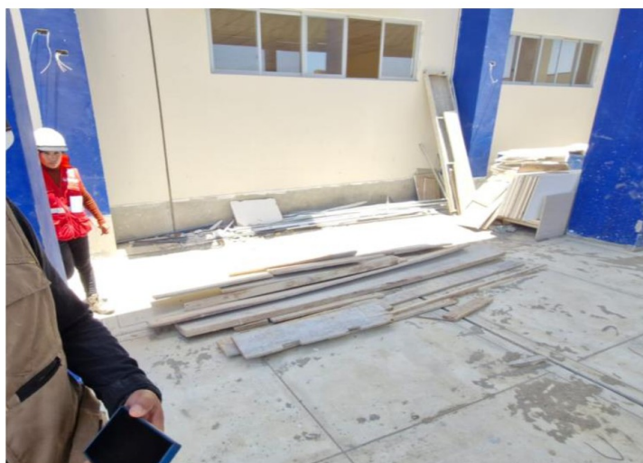
Fotografía n.º12. - Se visualiza interrupción de acceso, por falta de orden y limpieza en obra.
