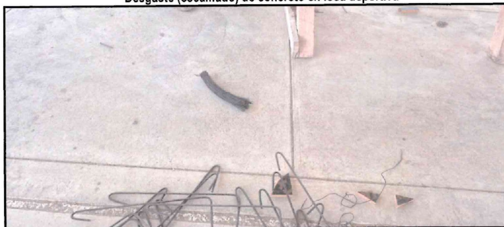
Fotografía n.º 3 Desgaste (escamado) de concreto en losa deportiva
