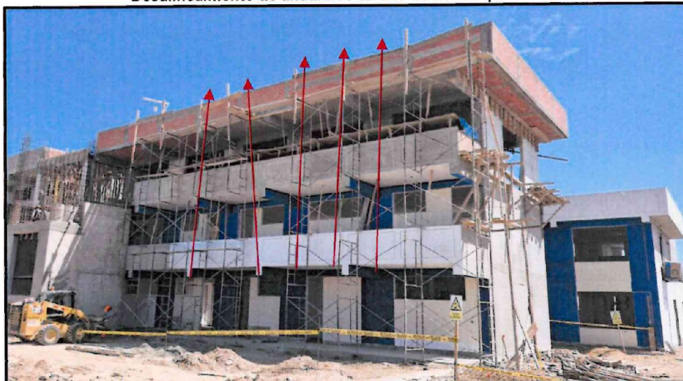
Fotografía n.º 9 Desalineamiento de andamios en frontis del bloque n.º 9B
