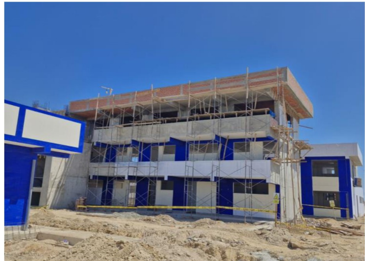
Fotografía n.º10.- Se visualiza instalación de andamios para trabajos en tercer piso, cuyo estado se encuentran desalineados.
