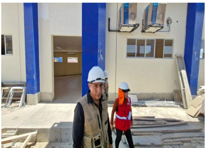
Fotografía n.º11. - Se visualiza interrupción de acceso, por falta de orden y limpieza en obra.
