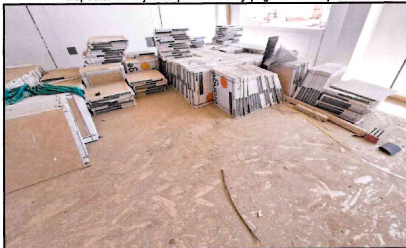
Fotografía n.º 6 Depósito de cajas de porcelanato y pegamento en piso
