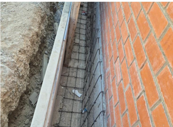
Fotografía n.º5.- Habitación de fierro en cuneta pluvial, sin considerar el retiro (mediante junta de separación) del cerco perimétrico.
