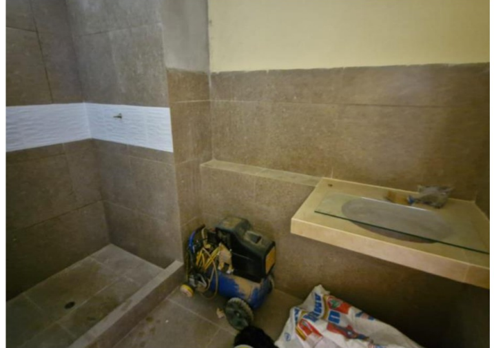
Fotografía n.º2.- Se visualiza el interior del bloque 18, carece de instalación de aparatos sanitarios.
