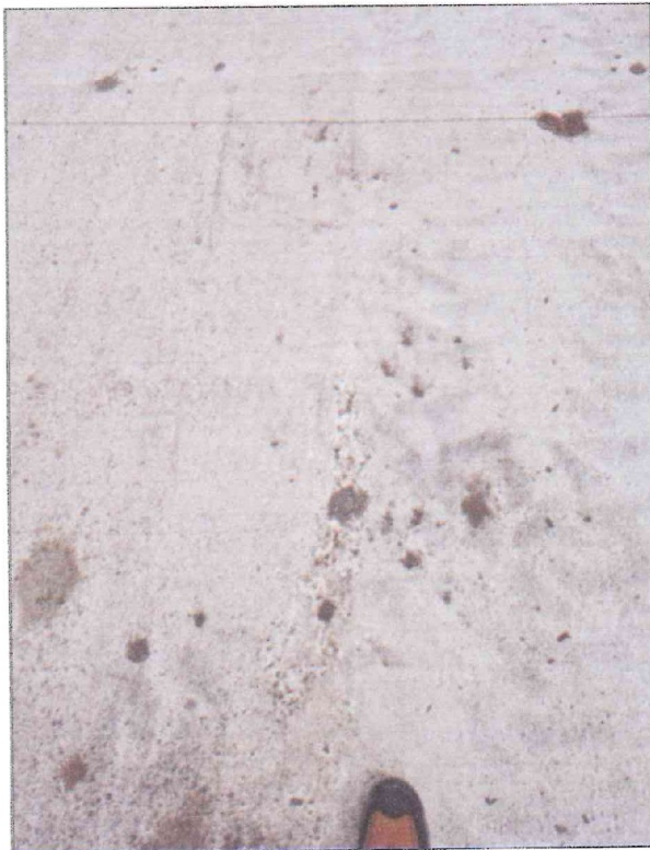
Fotografía n.º 8 Verificación de desgaste prematuro en Calle Alan García
