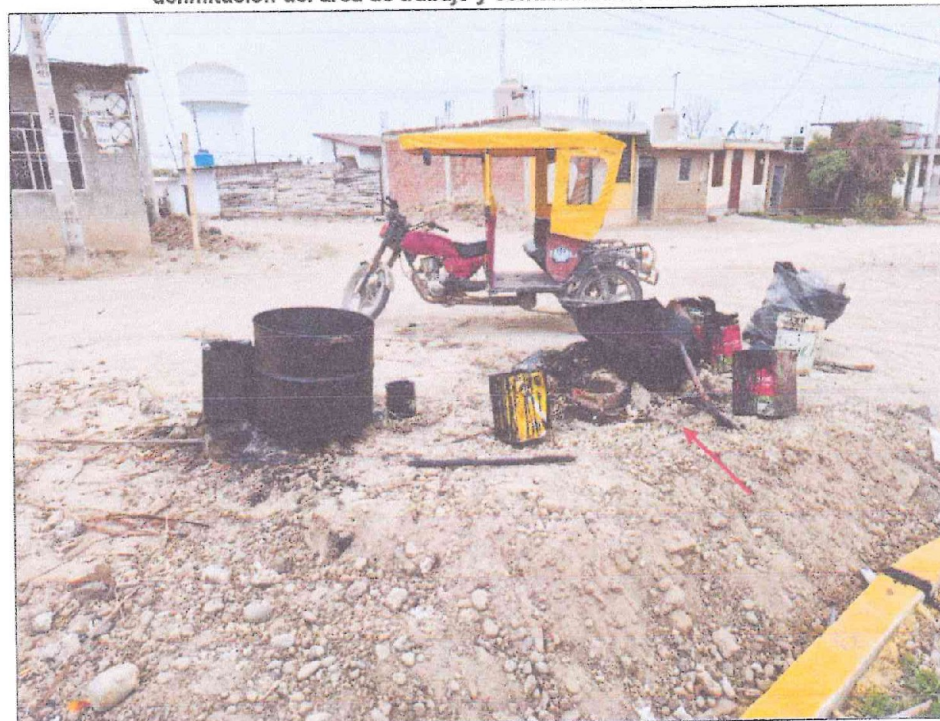
Imagen n.º 15 Preparación de Mezcla asfáltica en Calle José Olaya, se evidencia falta de supervisión, delimitación del área de trabajo y contaminación del suelo natural
