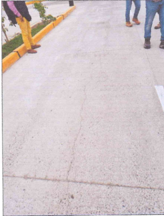
Fotografía n.º 5 Fisuras y desgaste prematuro en Calle José Olaya
