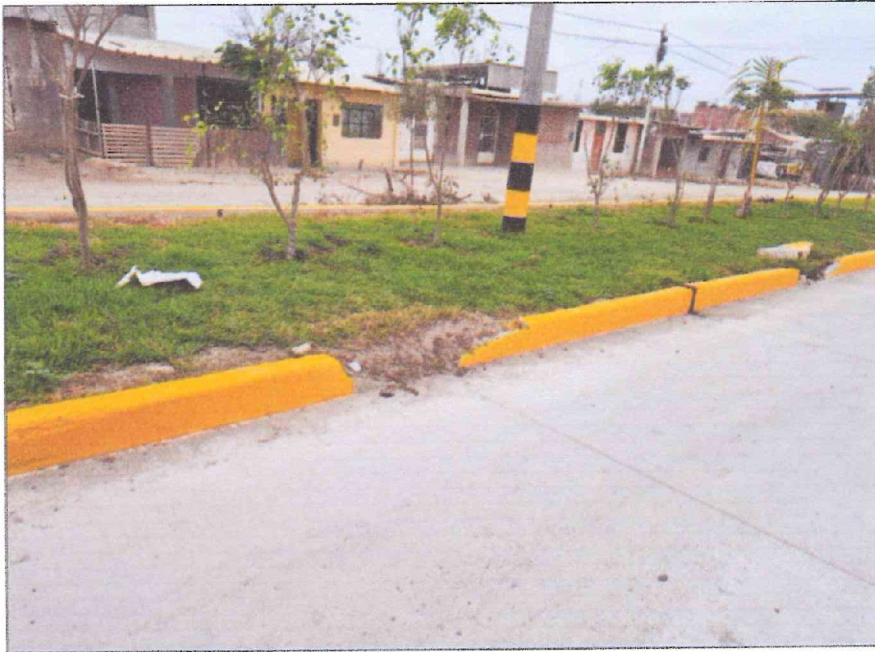
Fotografía n.º 7 Sardineles Rotos en Prolong. De Calle José Olaya
