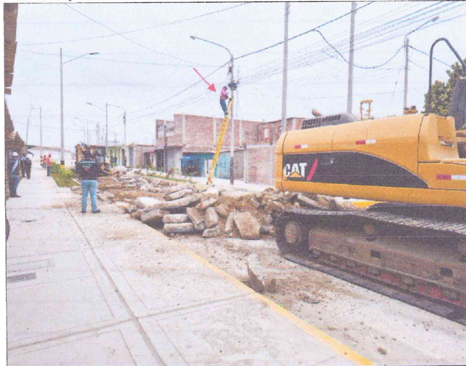
Imagen n.º 14 Trabajos en Calle Bardales sin la delimitación de seguridad del área de trabajo
