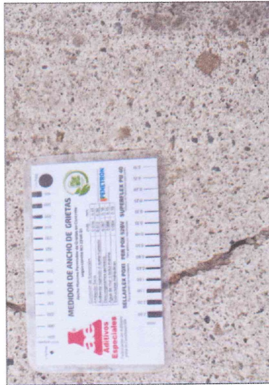
Fotografía n.º 9 Fisuras de 1.5mm en Alan García
