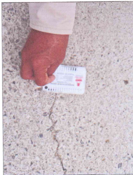
Fotografía n.º 6 Se verifican fisuras entre 0.5mm a más de 1.5mm en Calle José Olaya
