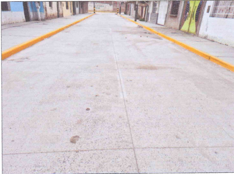
Fotografía n.º 13 Calle Víctor Raúl se evidencia desgaste prematuro
