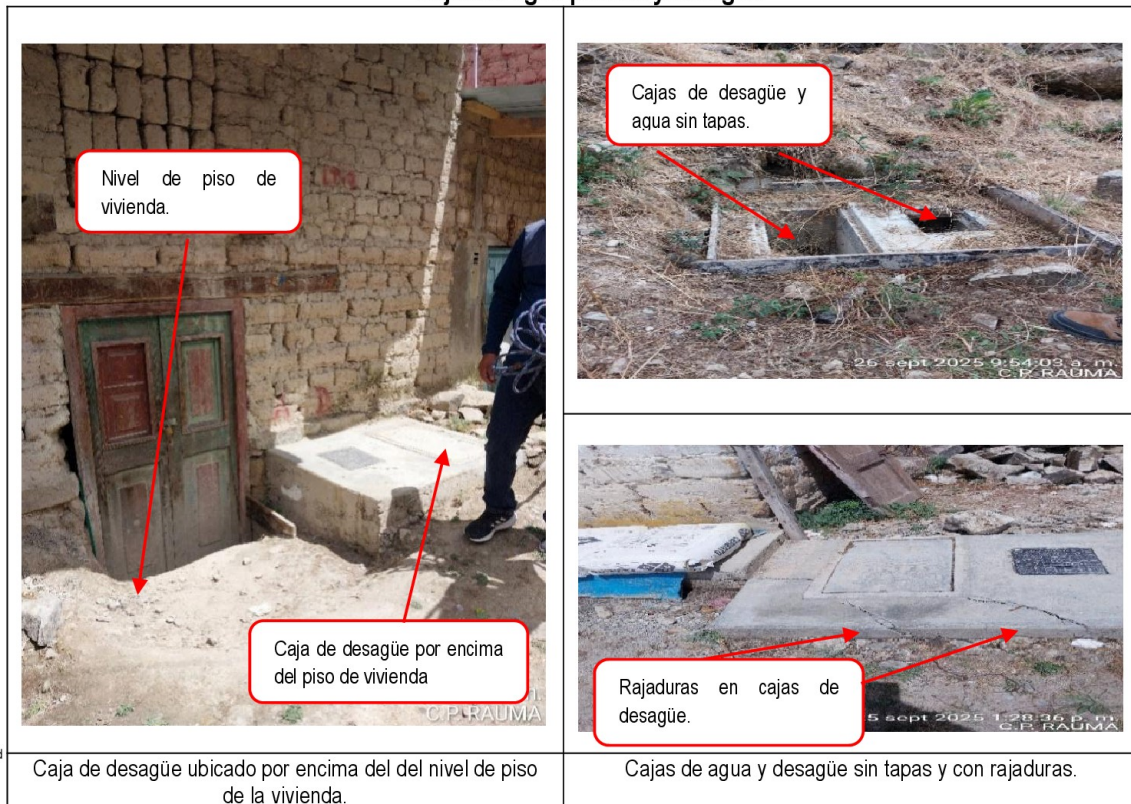
Imagen n.º 14 Cajas de agua potable y desagüe
