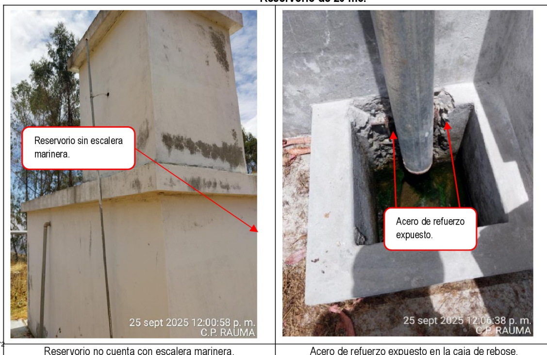
Reservorio no cuenta con escalera marinera.
