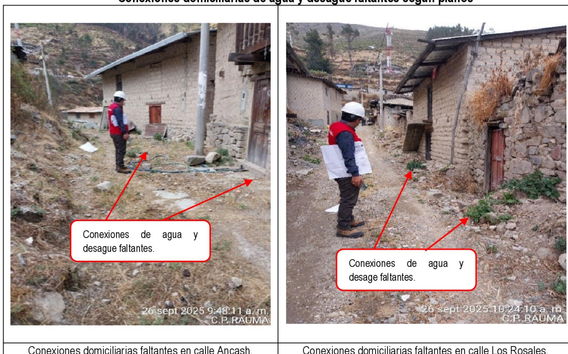
Imagen n.º 15 Conexiones domiciliarias de agua y desagüe faltantes según planos
