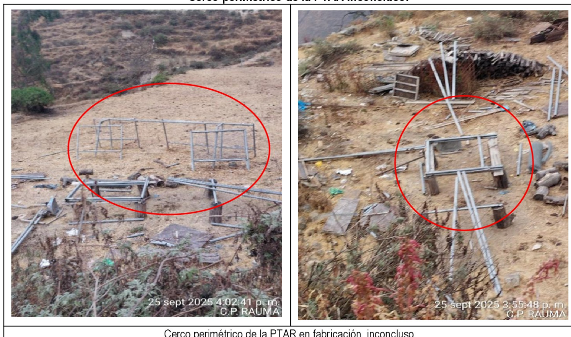
Imagen n.º 10 Cerco perimétrico de la PTAR inconcluso.
