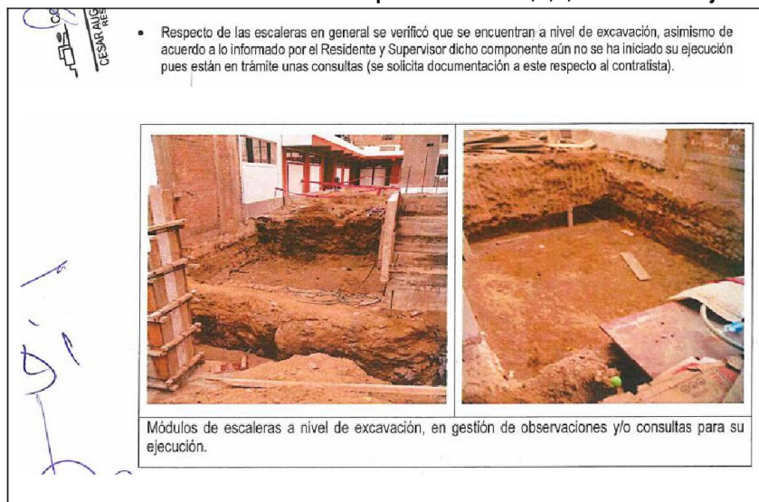
Imagen n.º 21 Comisión de Control Verifica in situ que escaleras 1,2,3,4 aun no se ejecutan
