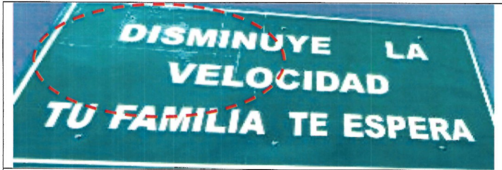
Imagen fotográfica n.º 4: Se observa señal informativa con presencia de ranuras de empalme en la lámina reflectiva, ubicada en la progresiva 15+400.
