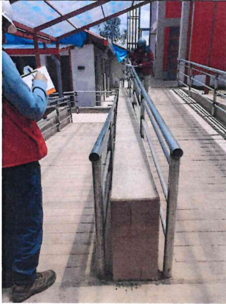
Baranda de ingreso en rampa 1 inconclusa
