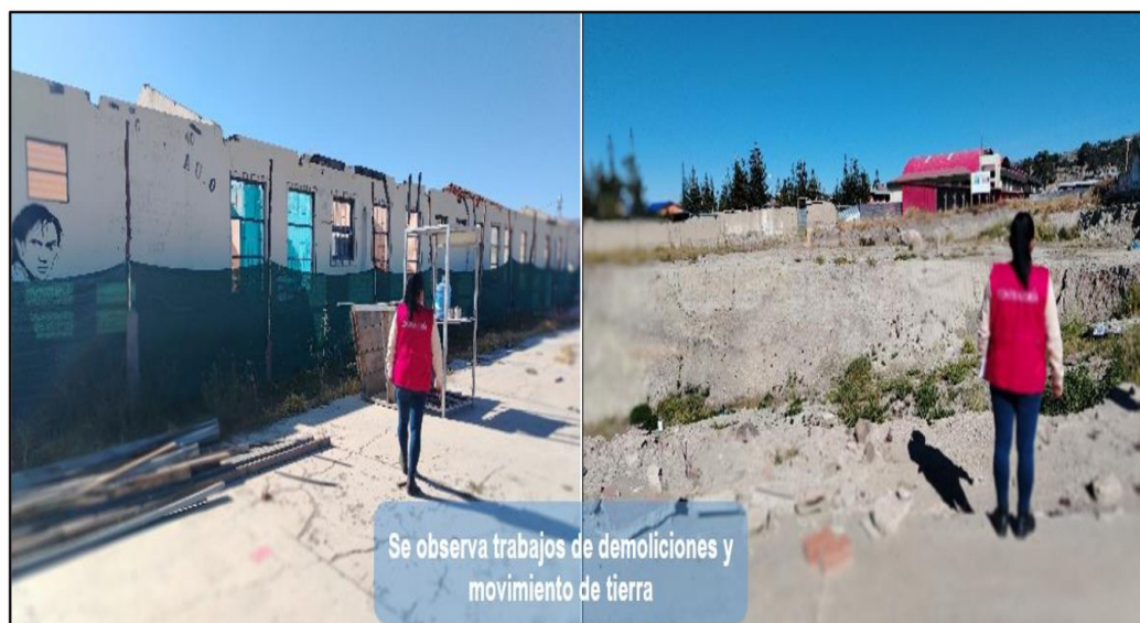
Imagen n.º 1 Fotografías sobre la paralización del Hospital Principal de Puquio
