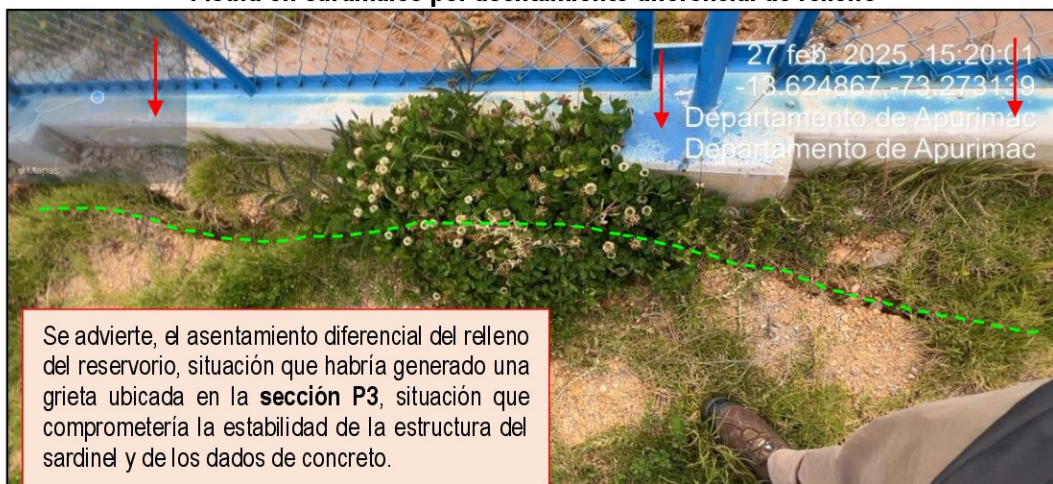
Imagen n.º 17 Fisura en sardinales por asentamiento diferencial de relleno
