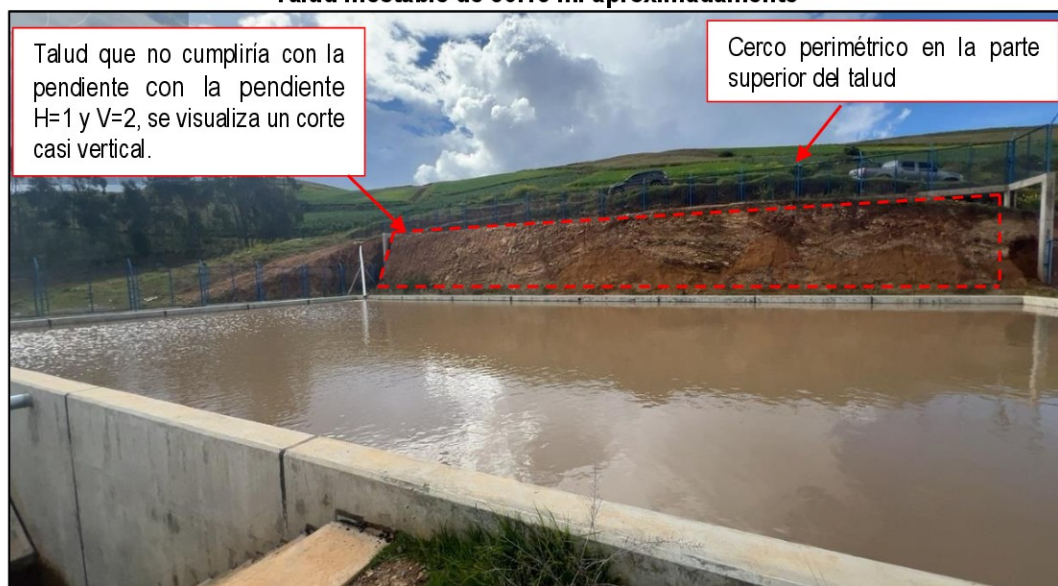
Imagen n.º 30 Talud inestable de 36.13 ml aproximadamente
