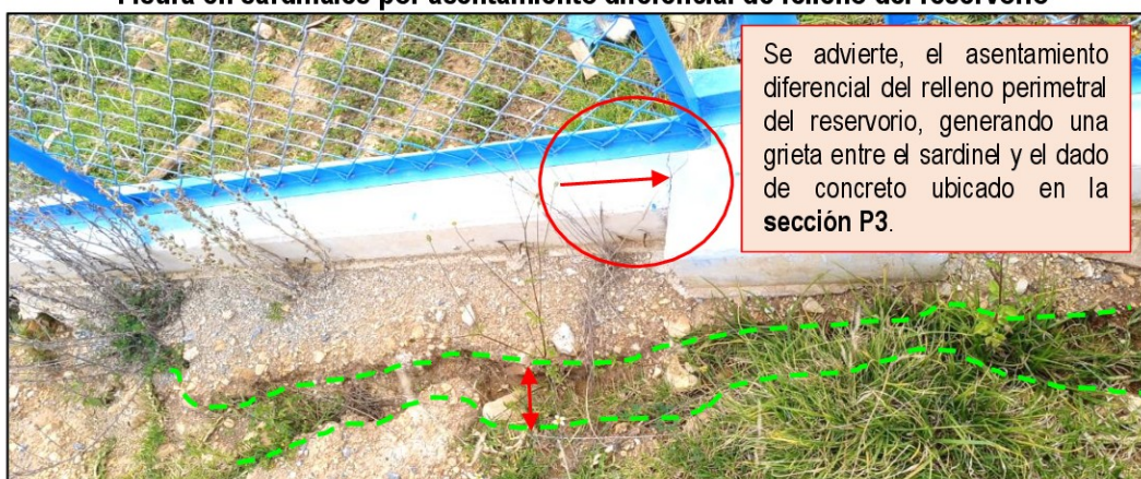
Imagen n.º 18 Fisura en sardinales por asentamiento diferencial de relleno del reservorio
