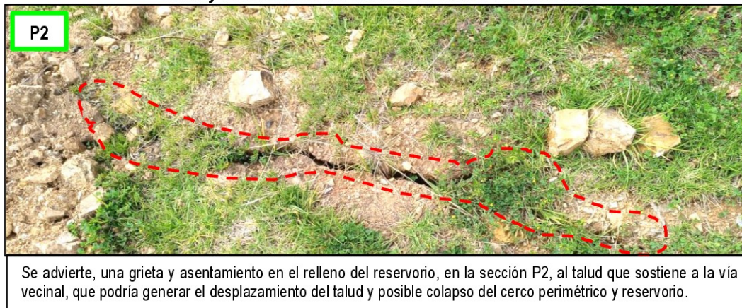
Imagen n.º 5 Grieta y asentamiento del material de relleno del reservorio
