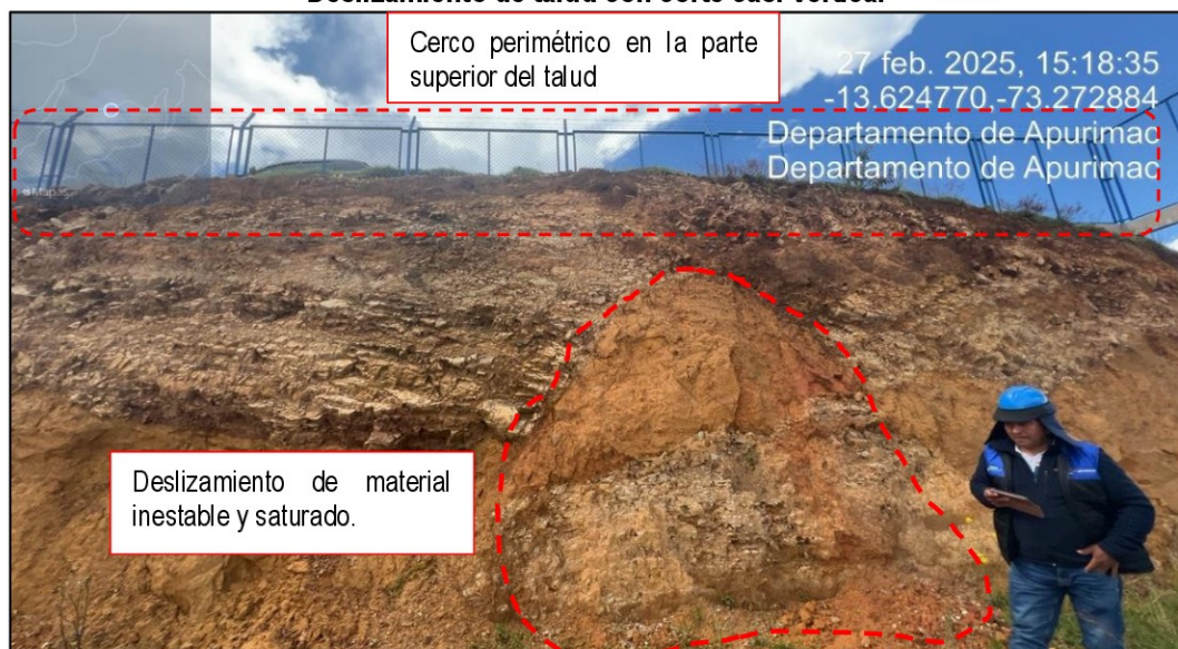
Imagen n.º 31 Deslizamiento de talud con corte casi vertical
