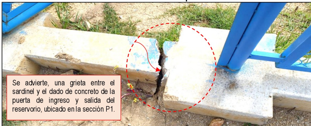
Imagen n.º 14 Grieta en el sardinel del cerco perimétrico
