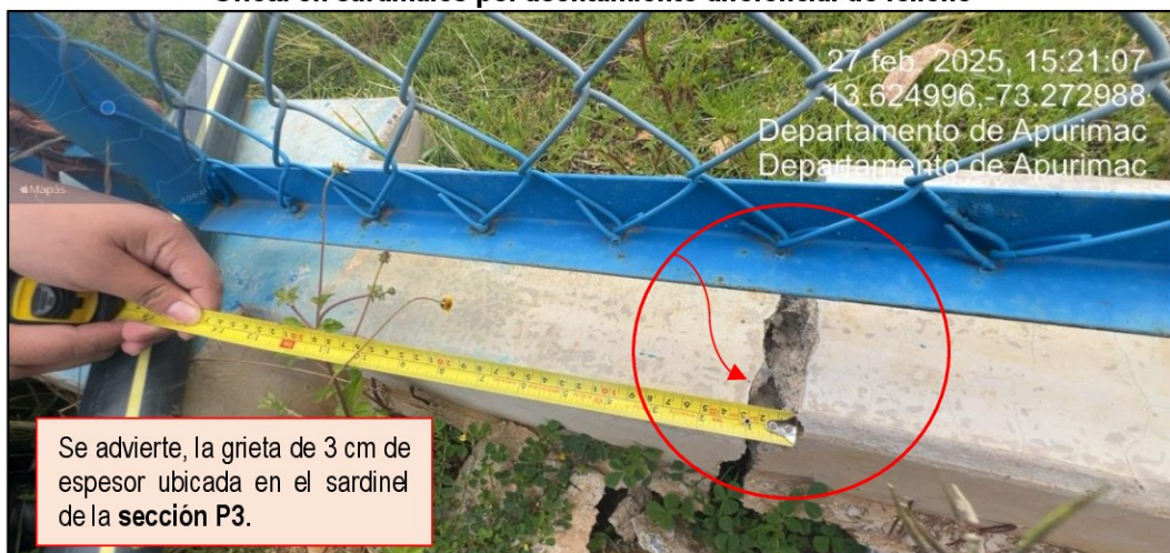
Imagen n.º 19 Grieta en sardinales por asentamiento diferencial de relleno
