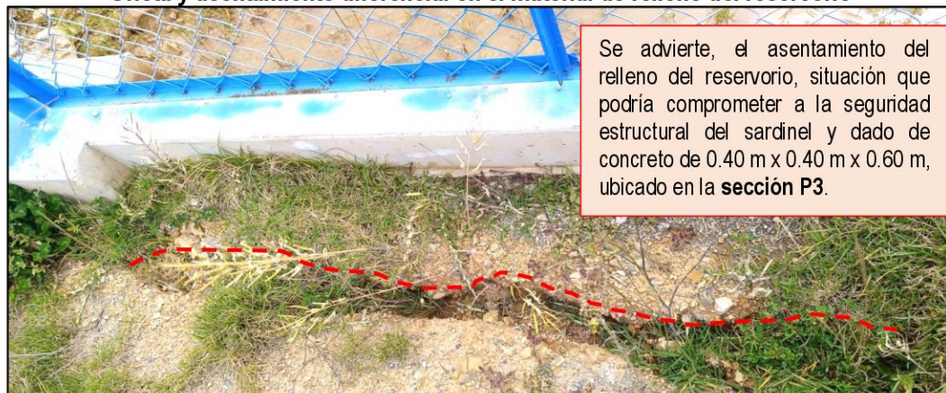
Imagen n.º 15 Grieta y asentamiento diferencial en el material de relleno del reservorio
