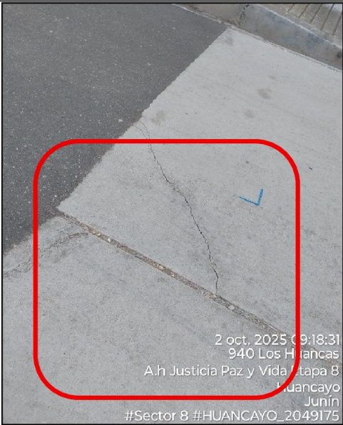
Imagen n.º 15: Pavimento rígido con fisuras en la intersección de Jr. los Huancas y Jr. Los Porkas.
