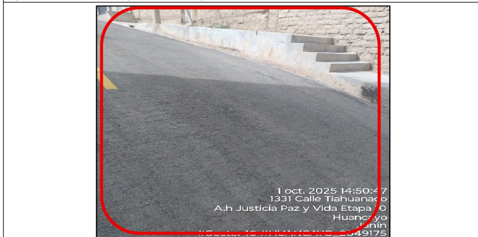
Imagen n.º 9: Carpeta asfáltica presenta fisuras longitudinales/transversales con apertura visible de aproximadamente de 12 m por el ancho del pavimento asfáltico.
