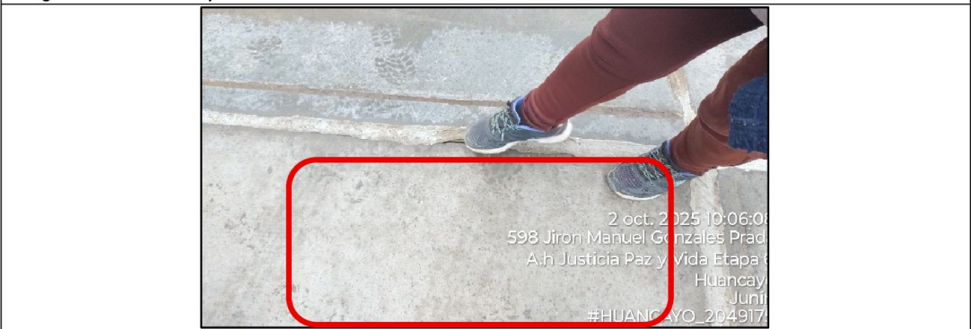
Imagen n.º 18: Deficiente ejecución del sellado elastomérico en la intersección Jr. Manuel Gonzales Prada y Jr. Ciro Alegría (sector n.º 6).
