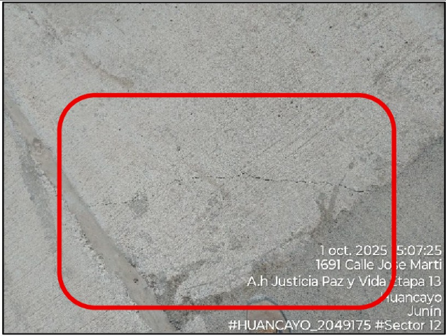
Imagen n.º 14: Pavimento rígido con fisura en la calle José Martín altura del n.º 1691.
