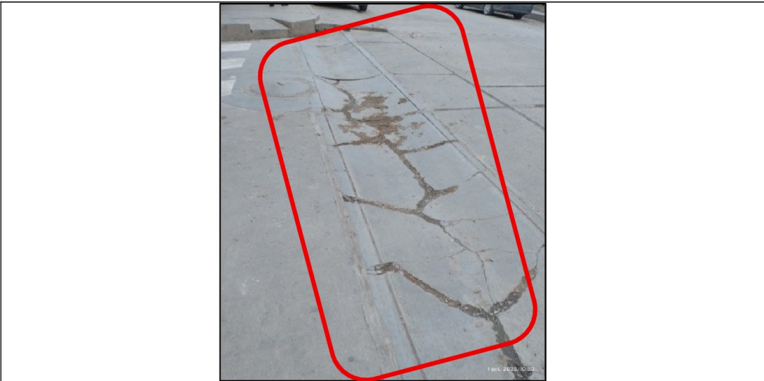
Imagen n.º 11: Baden de concreto con grietas visibles en toda la estructura ubicado en la intersección de la Av. Cultural con el Jr. Manuel Escorsa.
