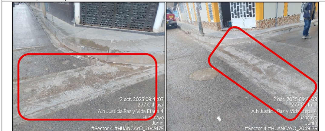
Imagen n.º 13: Badén de concreto con grietas visibles en toda la estructura ubicado en la intersección Jirón Ciro Alegría con Av. Independencia (sector n.º 4).
