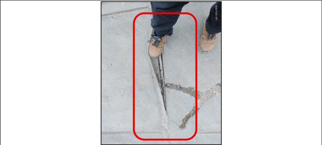
Imagen n.º 17: Deficiente ejecución del sellado elastomérico en la intersección de la Av. Cultural con el Jr. Manuel Escorsa.
