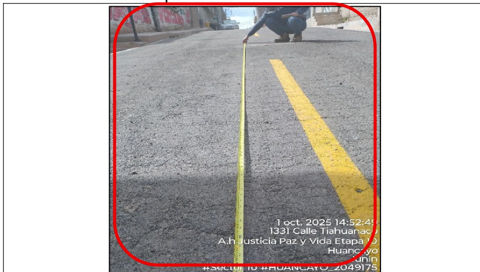
Imagen n.º 8: Carpeta asfáltica presenta fisuras longitudinales/transversales con apertura visible de aproximadamente de 12 m por el ancho del pavimento flexible.
