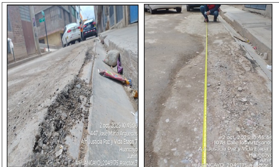
Imagen n.º 7: Pendiente deficiente en la calzada derecho de la carpeta asfáltica en circuito 26 de julio (sector n.º 10), asimismo, se presencia hundimiento en dichas zonas, de aproximadamente dimensiones de 9 m x 0.80m adyacente a la cuneta de concreto.
