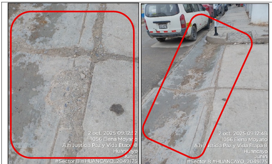
Imagen n.º 12: Badén de concreto con grietas visibles en toda la estructura ubicado en la intersección Jirón Elena Moyano con Jr. Los Mercaderes (sector n.º 8).
