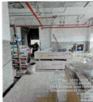
Actividades de Porcelanato en pared, canalizaciones de agua contra incendio, canalización de red de desagüe, canalizaciones sistema HVAC.
