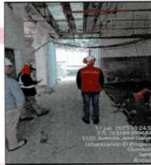
Actividades de Bandejas eléctricas, tuberías para gases medicinales, aire comprimido y vacío.
