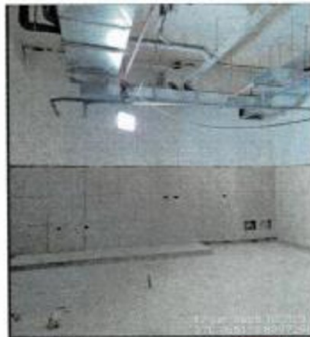
Actividades de Porcelanato en pared, canalizaciones de agua contra incendio, canalización de red de desagüe, canalizaciones sistema HVAC.
