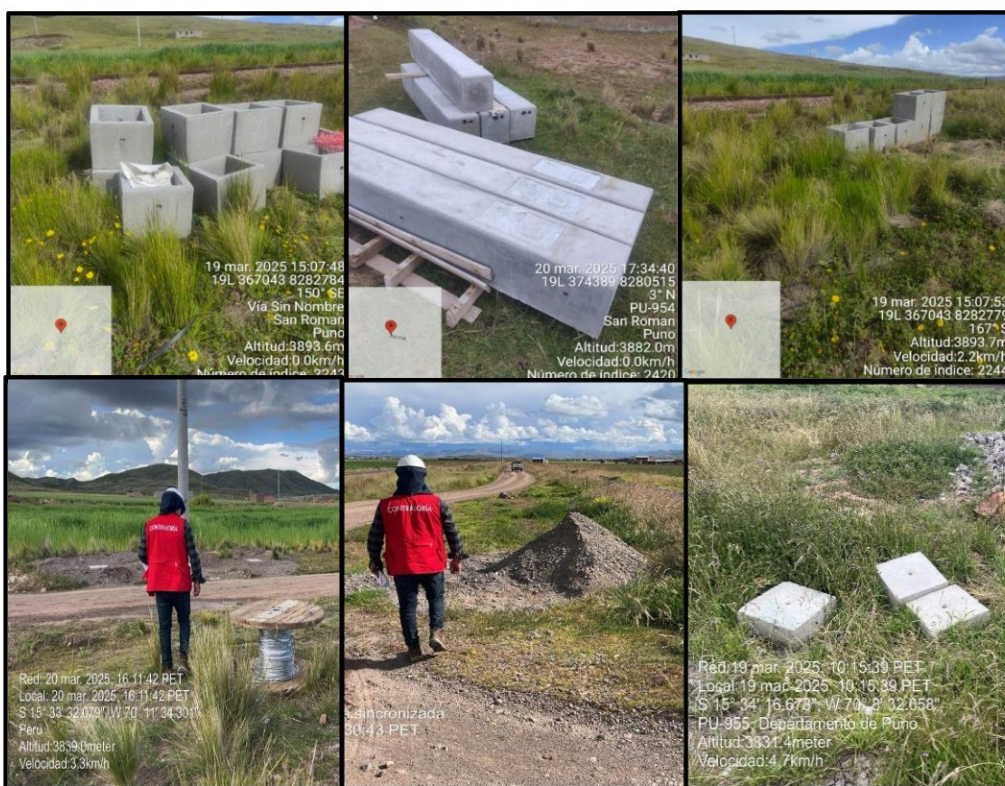
Fotografías n.ºs 38, 39, 40, 41, 42 y 43 Materiales de obra sin guardiana en zona pública.
