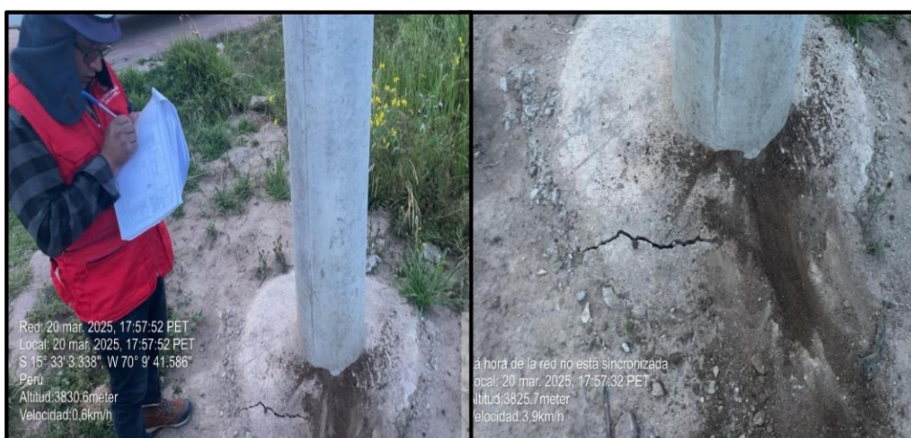
Fotografías n.ºs 52 y 53 Poste de red con agrietamiento en la cimentación.
