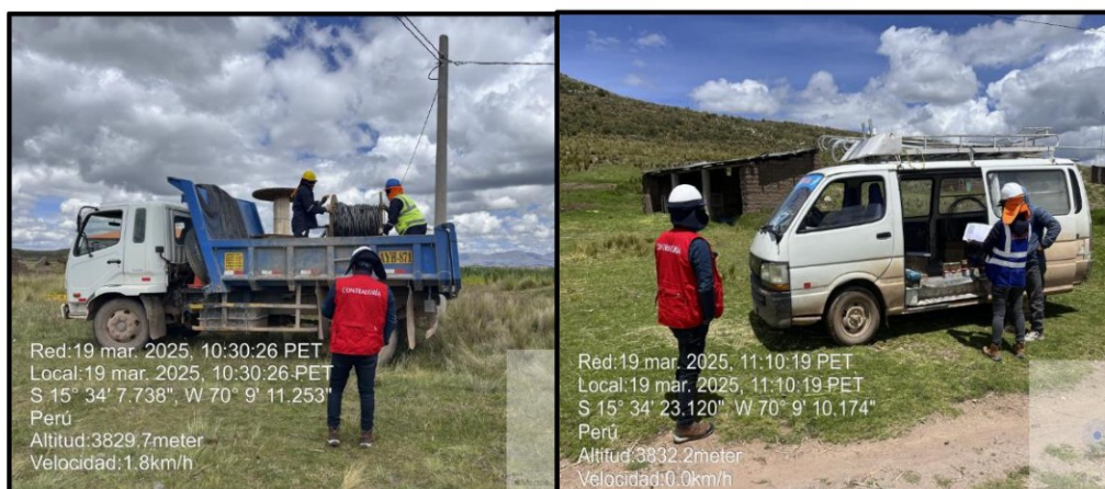
Fotografías n os 1, 2, 3, 4, 5, 6, 7, 8, 9, 10, 11 y 12 Obra en ejecución y falta de trabajos para culminación
