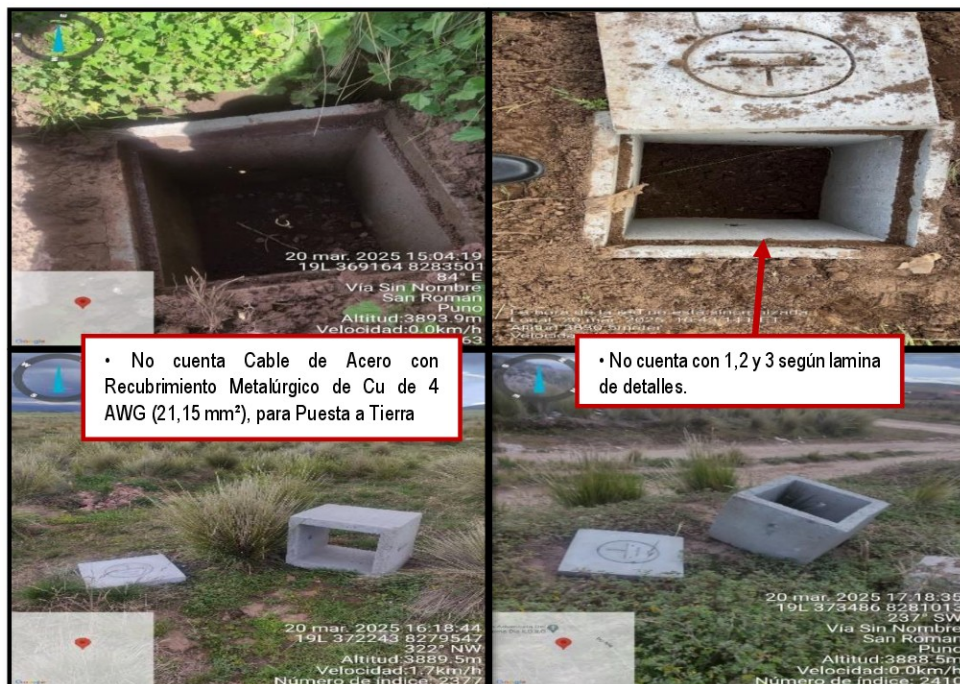
Fotografías n° 54, 55, 56, 57, 58 y 59 Puesta a tierra sin instalación
