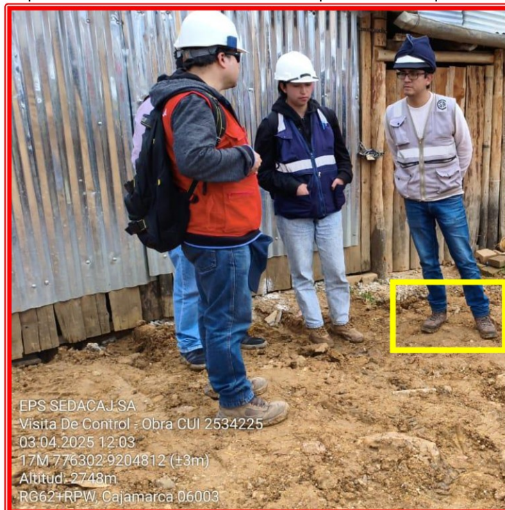
Fotografía n.º 2: Especialista de control de calidad de la supervisión sin zapatos de seguridad en obra.
