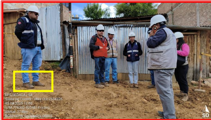
Fotografía n.º 1: Ingeniero Residente de Obra sin zapatos de seguridad en obra.
