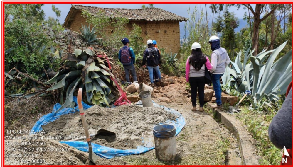
Fotografía n.º 5: Personal clave de la residencia y supervisión / no se observa el equipo vibrador para el concreto.
