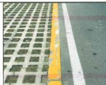
FOTOGRAFÍA N° 49 SARDINEL SUMERGIDO CON RESQUEBRAJAMIENTO DE PINTURA
