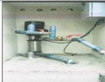
FOTOGRAFÍA N° 79 ELECTROBOMBA UBICADA EN EL INTERIOR DEL CUARTO DE BOMBAS DE LA AV. ANCHOVETA CON LA AV. AGRARIA
