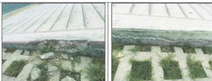
FOTOGRAFÍA N°s 30 Y 31 RAMPAS CON PRESENCIA DE SALITRE Y ROTURA EN EL CONCRETO DE LOS LATERALES
