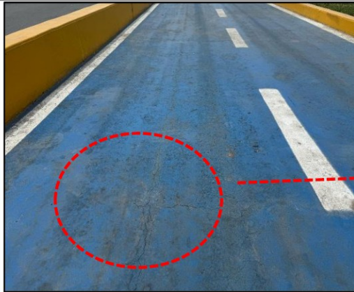
Fisuras observadas en la carpeta asfáltica de la ciclovía
