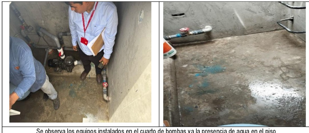
Se observa los equipos instalados en el cuarto de bombas y la presencia de agua en el piso Fuente: Acta n.° 023-2025-MDNCH-OCI/3948 de 12 de marzo de 2025.
