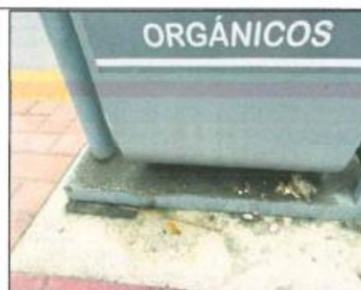
FOTOGRAFÍA N° 13 SOPORTE DE LOS PARANTES CON PRESENCIA DE OXIDACIÓN
