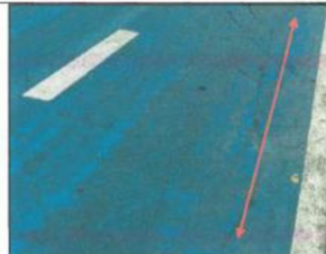
FOTOGRAFÍA N° 68 FISURA A LO LARGO DE LA CICLOVÍA
