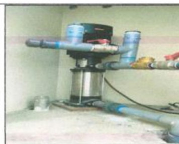
FOTOGRAFÍA N° 75 ELECTROBOMBA UBICADA EN EL INTERIOR DEL CUARTO DE BOMBAS DE LA AV. NACIONES UNIDAS CON LA AV. AGRARIA
