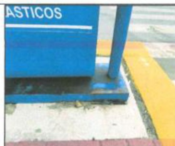
FOTOGRAFÍA N° 12 BASE DE LOS TACHOS DE BASURA CON PRESENCIA DE OXIDACIÓN
