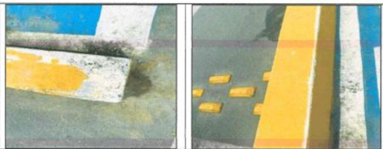
FOTOGRAFÍA N°s 10 Y 11 SARDINEL PERALTADO CON DESGASTAMIENTO DE LA PINTURA ENTRE EL TRAMO DE CALLE 1 Y JR. LOS PUERTOS
