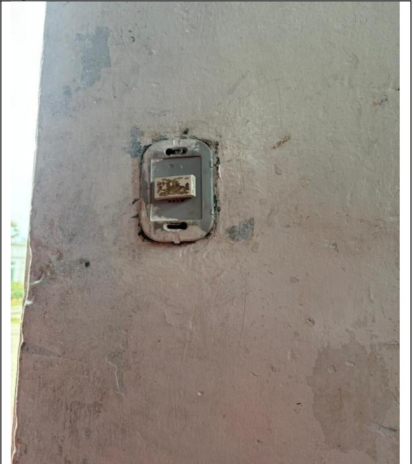
Interruptor sin tapa en Dormitorio
