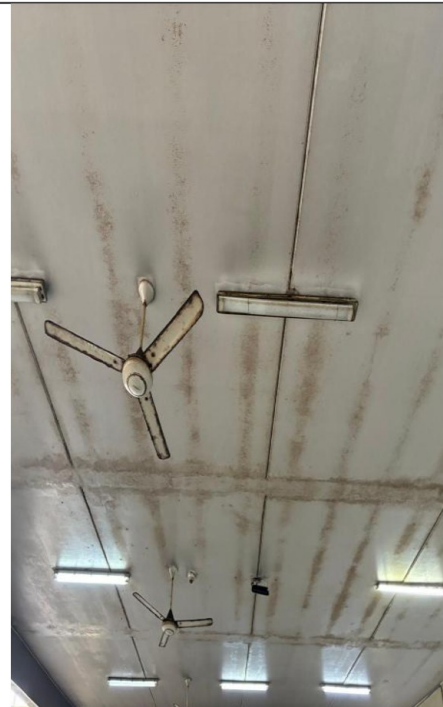
Ventiladores y flourescentes del comedor malogrados (no funcionan)
