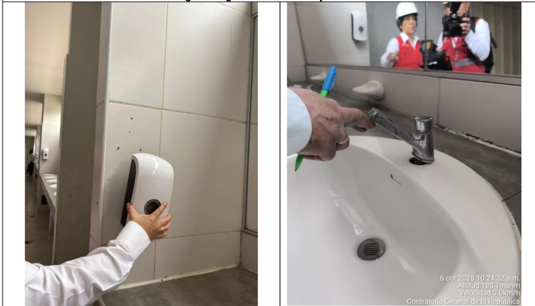
Dispensadores de jabón rotos
