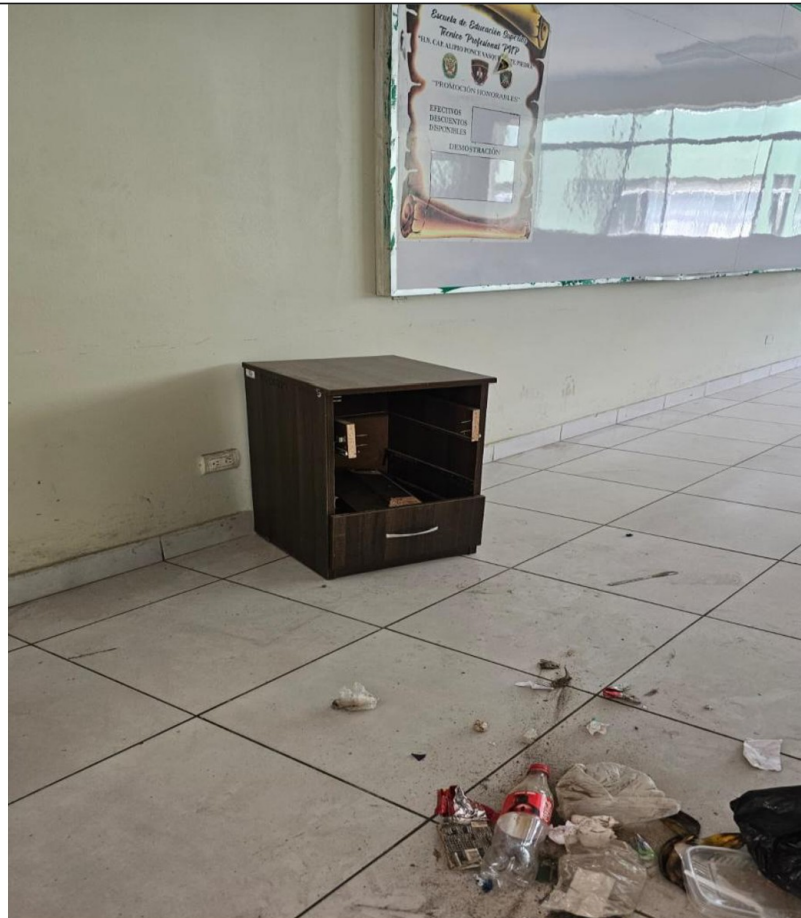
Muebles en mal estado y aulas con desperdicio
