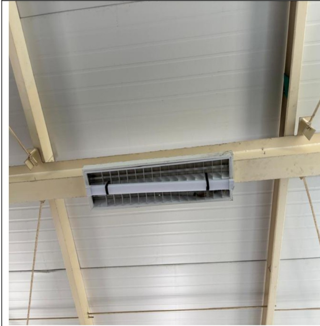
Fluorocentes sostenidas con cinta aislante en Dormitorio
