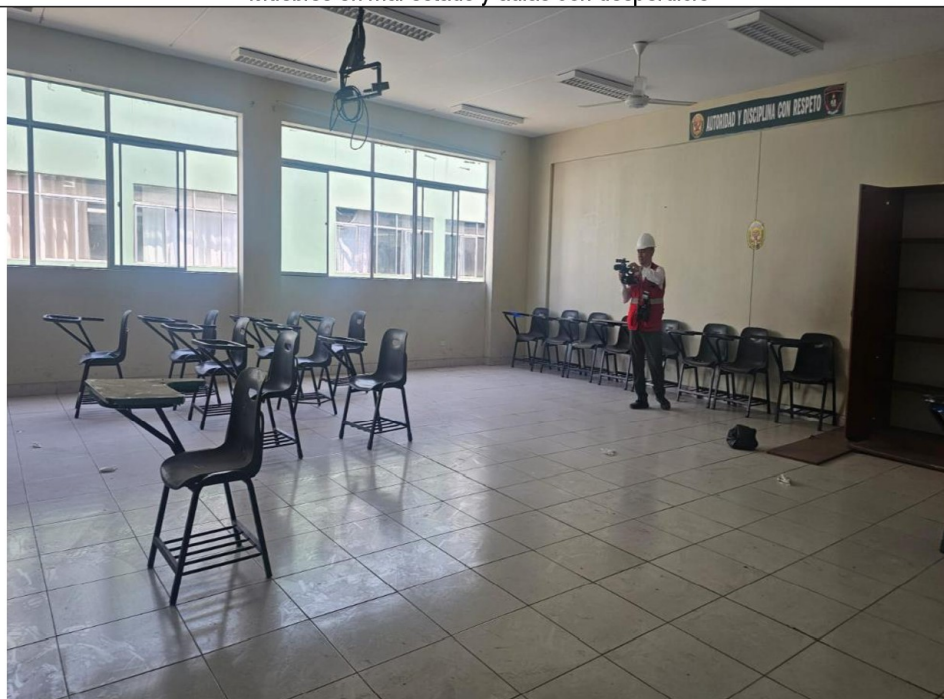
Aulas en condiciones de abandono con muebles en estado precario
