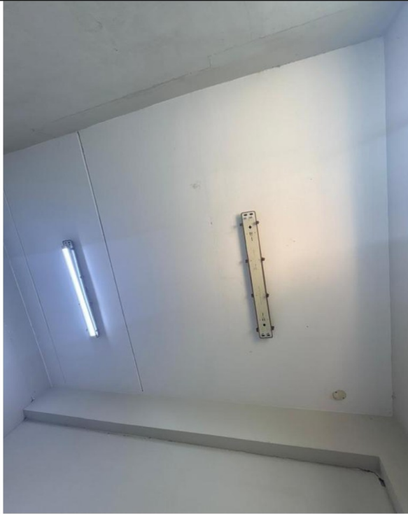
Flourescentes de la cocina malogrados
