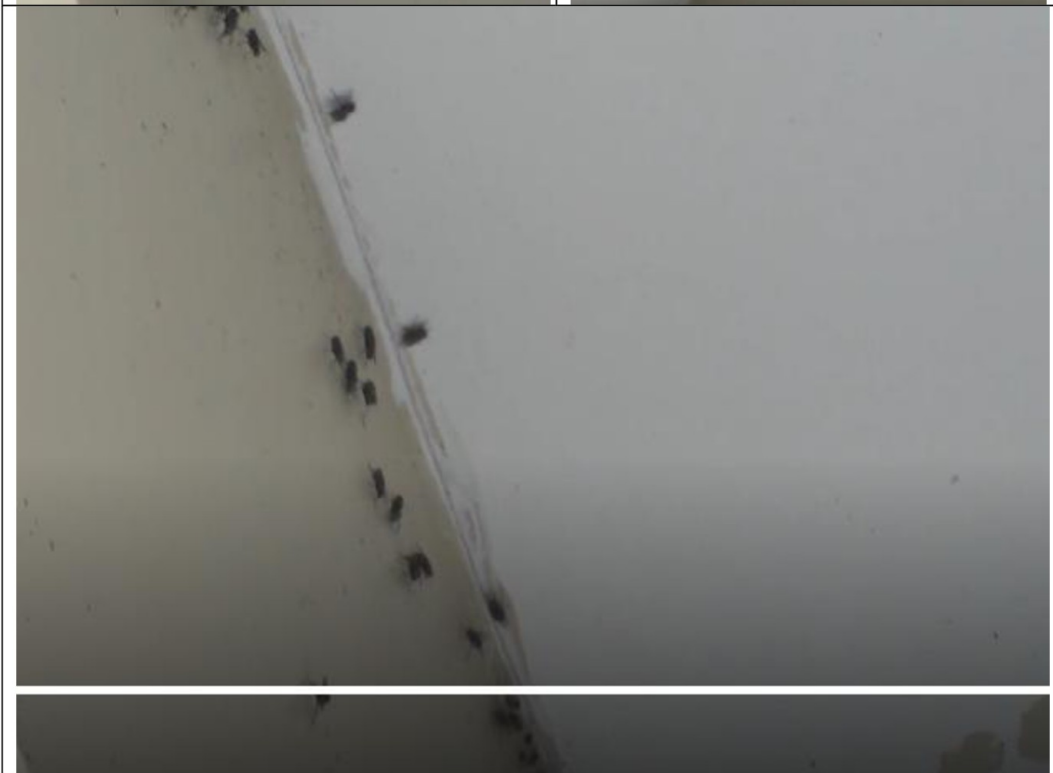
Se observa gran cantidad de moscas en el techo y paredes del comedor de los alumnos
