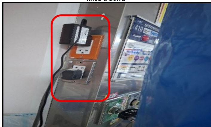
Cabecera de cama con dos (2) tomacorrientes del tipo doble universal con línea a tierra
