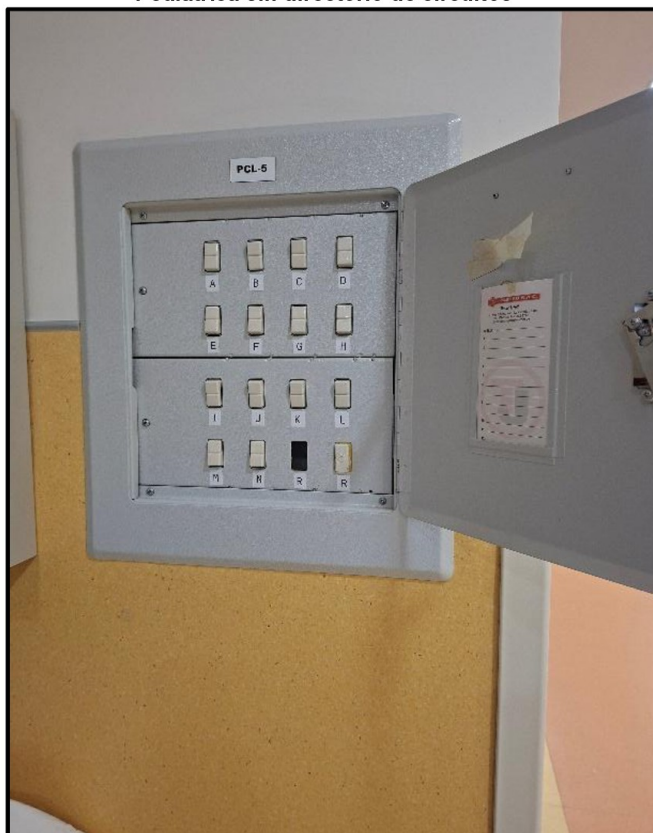
Toma Fotográfica N° 12 Tablero eléctrico ubicado en el servicio de Unidad de Cuidados Intensivos Pediátrica sin directorio de circuitos
