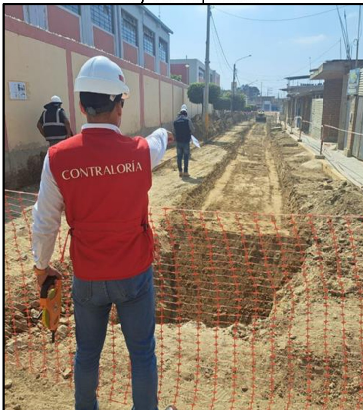
Imagen n.º 8 Personal realizando trabajos de relleno de zanja y perfilado con un minicargador, no se evidencia trabajos de compactación.
