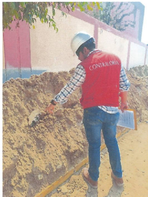
Fotografía n.º 10.- Se visualizan desechos de asfalto en el material de desmonte cerca de la zona de relleno de zanja
