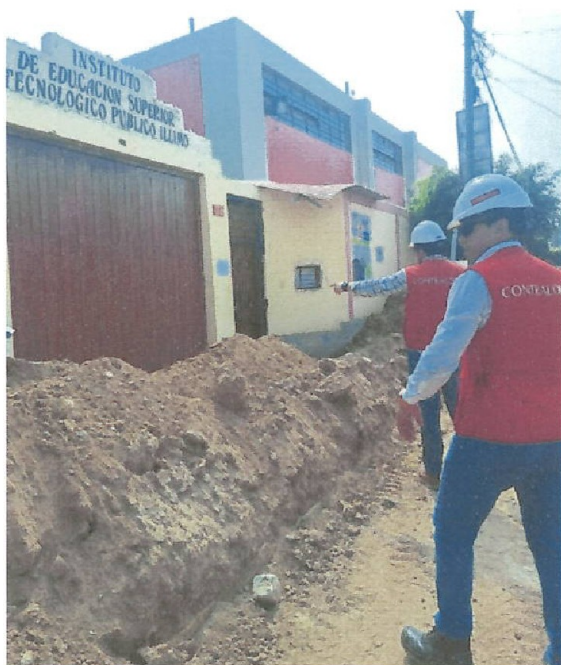
Fotografía n.º 9.- Se observa material de desmonte en toda la vereda de la calle 22 de noviembre obstaculizando el ingreso al Instituto Superior Tecnológico Público Illimo.
