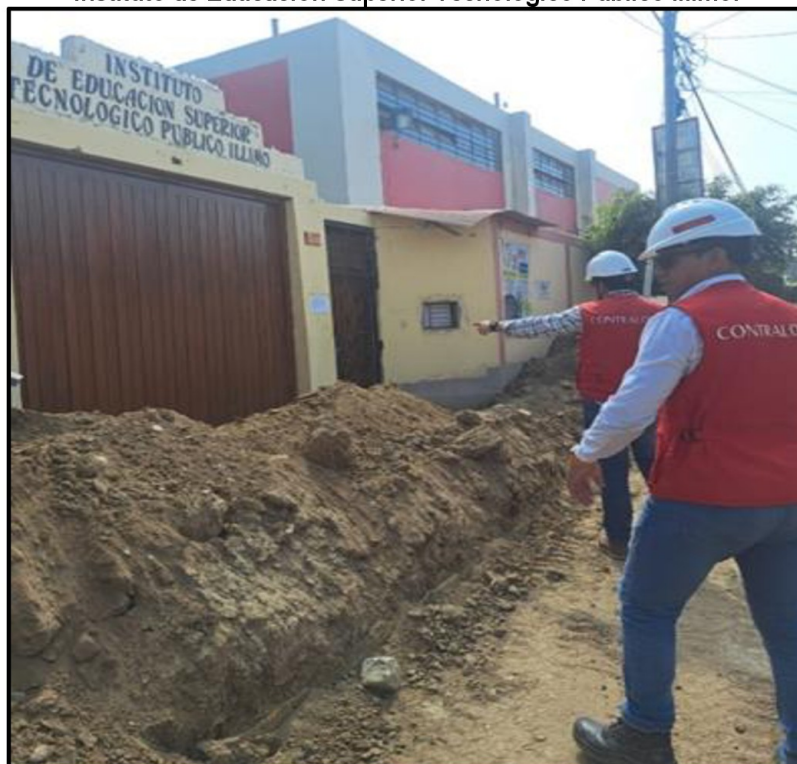
Imagen n.º 5 Material excedente colocado en la vereda de la calle 22 de noviembre, impidiendo el ingreso, por uno de los accesos, al Instituto de Educación Superior Tecnológico Público ILLIMO.
