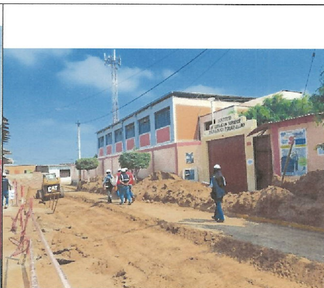
Fotografía n.º 2.- Se visualiza material de desmonte colocado al filo de la vereda de uno de los lados de la calle 22 de noviembre obstaculizando uno de los ingresos del Instituto de Educación Superior Tecnológico Público Íllimo .
