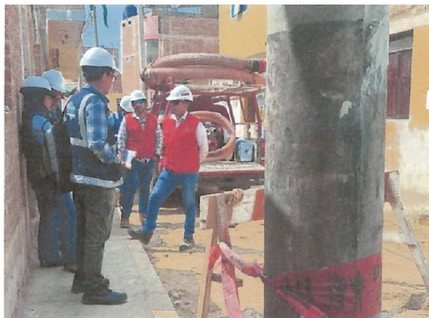
Fotografía n.º 13.- Se visualiza en el cruce de las calles Libertad y 7 de enero, las bombas del contratista en la camioneta sin realizar operaciones
