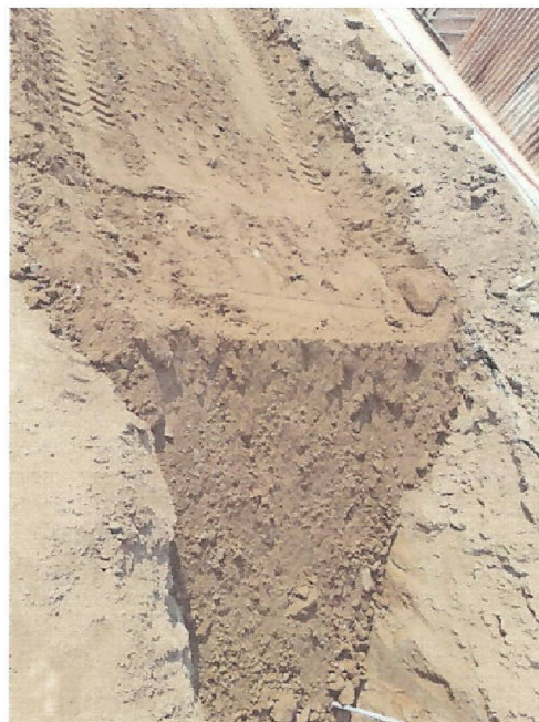
Fotografía n.º 6.- Se evidencia material de relleno colocado en zanja, no se evidencia trabajos de compactación, solo material suelto colocado.
