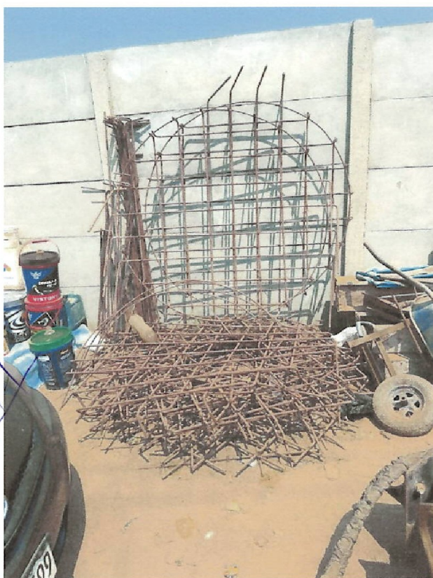
Fotografía n.º 15.- Se visualiza armadura de acero corrugado para construcción de los buzones en mal estado, oxidada y colocada a la interperie directamente al piso y sin techo que la cubra
