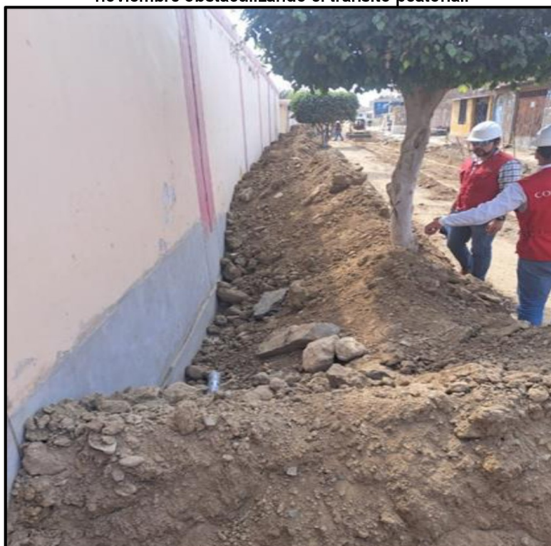
Imagen n.º4 Material excedente colocado en la vereda de la calle 22 de noviembre obstaculizando el tránsito peatonal.
