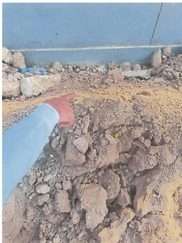
Fotografía n.º 8.- Se visualizan desechos de asfalto en el material de desmonte cerca de la zona de relleno de zanja
