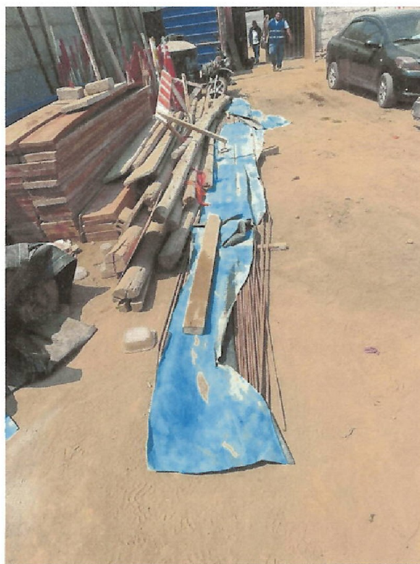
Fotografía n.º 16.- Se visualiza aceros corrugado almacenados, oxidados y colocados a la interperie directamente al piso y sin techo que la cubra
