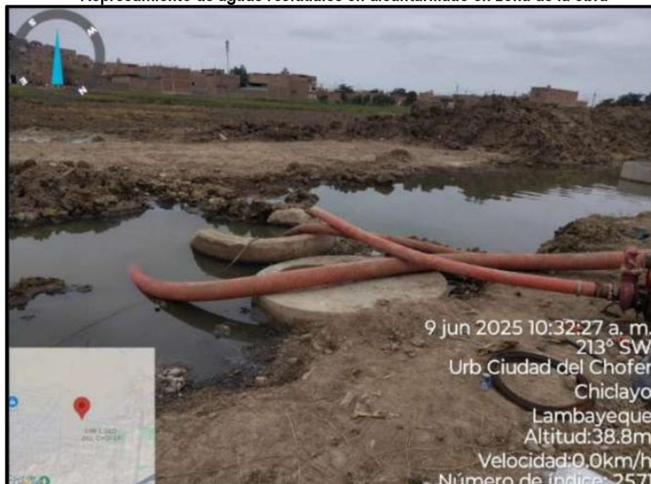
Imagen n.º 7 Represamiento de aguas residuales en alcantarillado en zona de la obra
