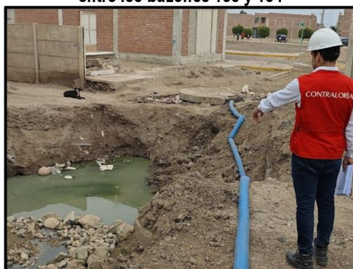
Imagen n.º 17 Acumulación de aguas servidas en el tramo entre los buzones 135 y 134
