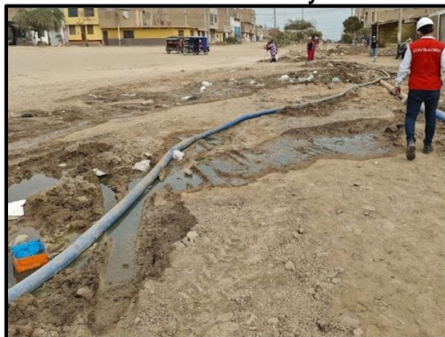
Imagen n.º 12 Acumulación de aguas servidas en el tramo entre los buzones 164 y 163
