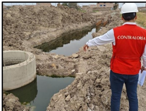
Imagen n.º 15 Acumulación de aguas servidas alrededor del buzón n.º 137
