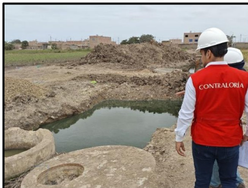
Imagen n.º 14 Acumulación de aguas servidas alrededor del buzón n.º 138
