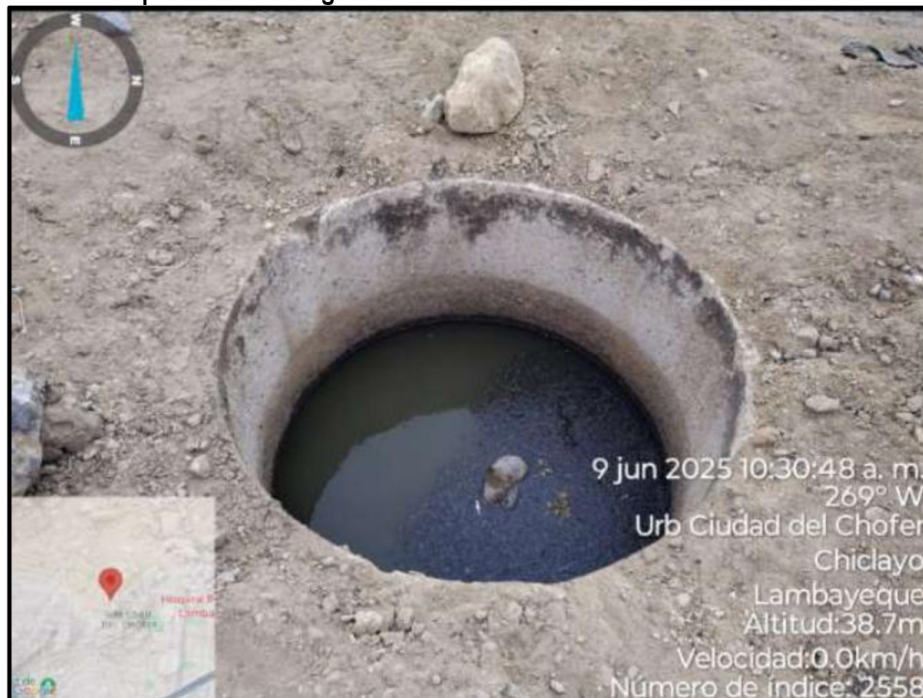
Imagen n.º 6 Represamiento de aguas residuales en alcantarillado en zona de la obra
