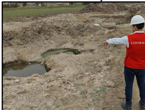
Imagen n.º 13 Acumulación de aguas servidas en el tramo entre los buzones 139 y 138
