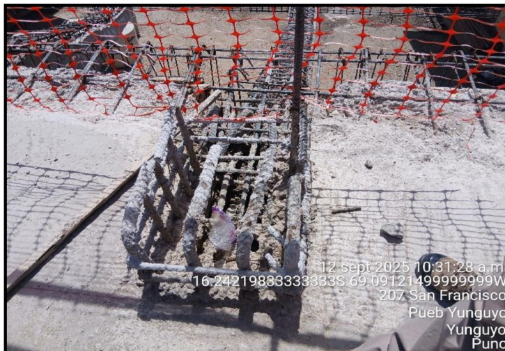
Imagen n° 5 Junta fría en vigas de concreto armado en bloque "A"
