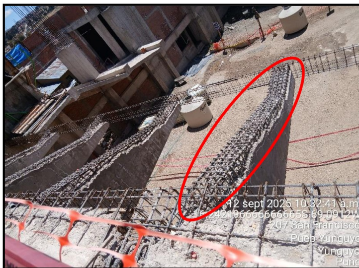
Imagen n° 4 Junta fría en vigas de concreto armado en bloque “A”
