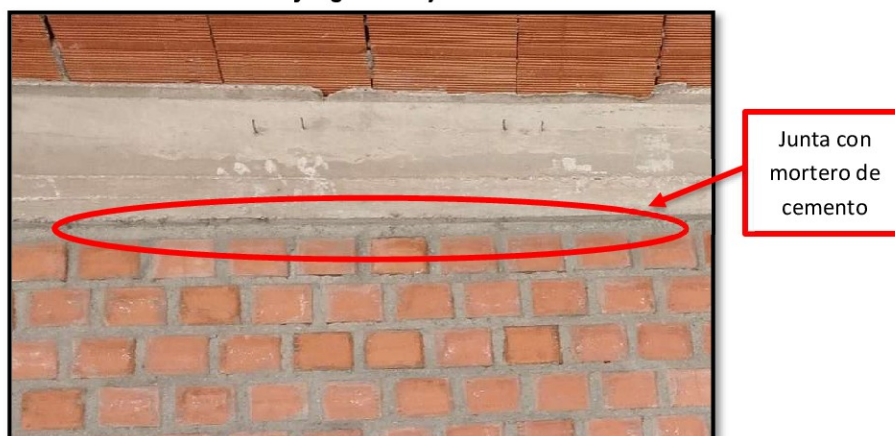
Imagen n° 4 Junta entre muro y viga en la ejecución de la obra
