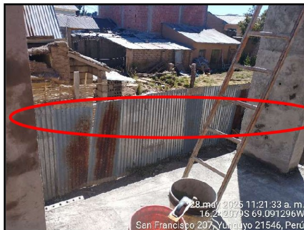
Imagen n° 7 Trabajos en altura sin barandas de seguridad
