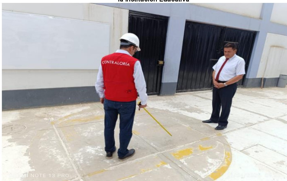
Fotografía n.º 6 Deterioro prematuro del pintado de la señalética de seguridad y evacuación, ubicado al ingreso de la Institución Educativa
