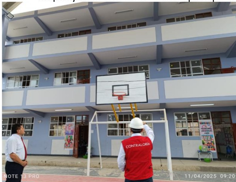
Fotografía n.º 5 Resquebrajamiento de los tableros de madera para la práctica del basketbol
