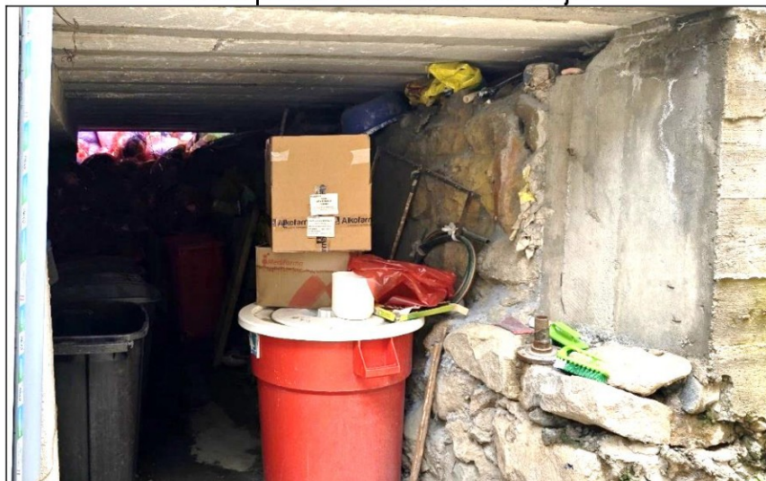
Imagen n.º 6 Pared de piedras sin revestimiento ni tarrajeo
