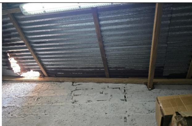
Fotografía n.º 12: Se evidencia la corrosión y desprendimiento
