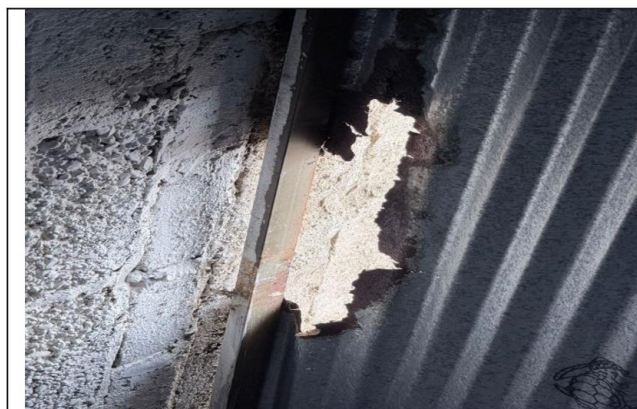
Fotografía n.º 11: Se evidencia la corrosión y desprendimiento
