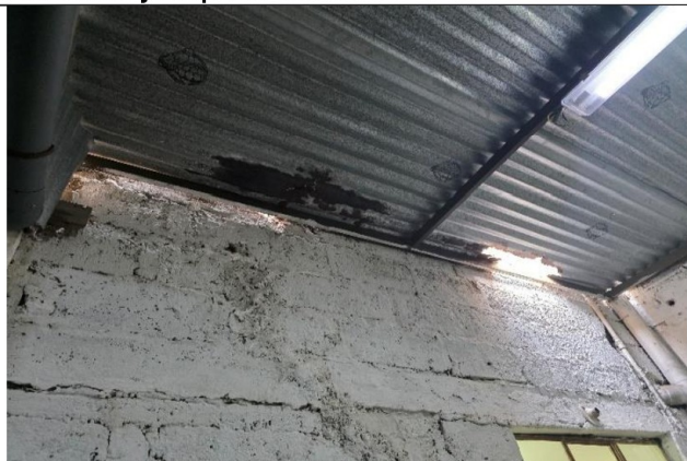
Fotografía n.° 10: Se evidencia la corrosión y desprendimiento
