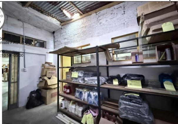
Fotografía n.° 9: Se evidencia la corrosión y desprendimiento
