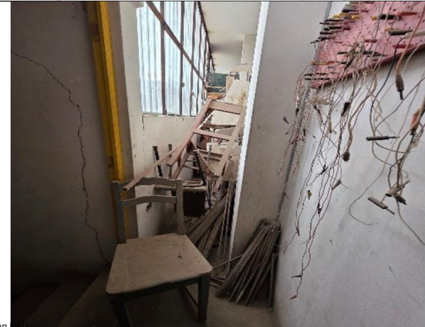
Fotografía n.º 17: Mobiliario arrinconado
