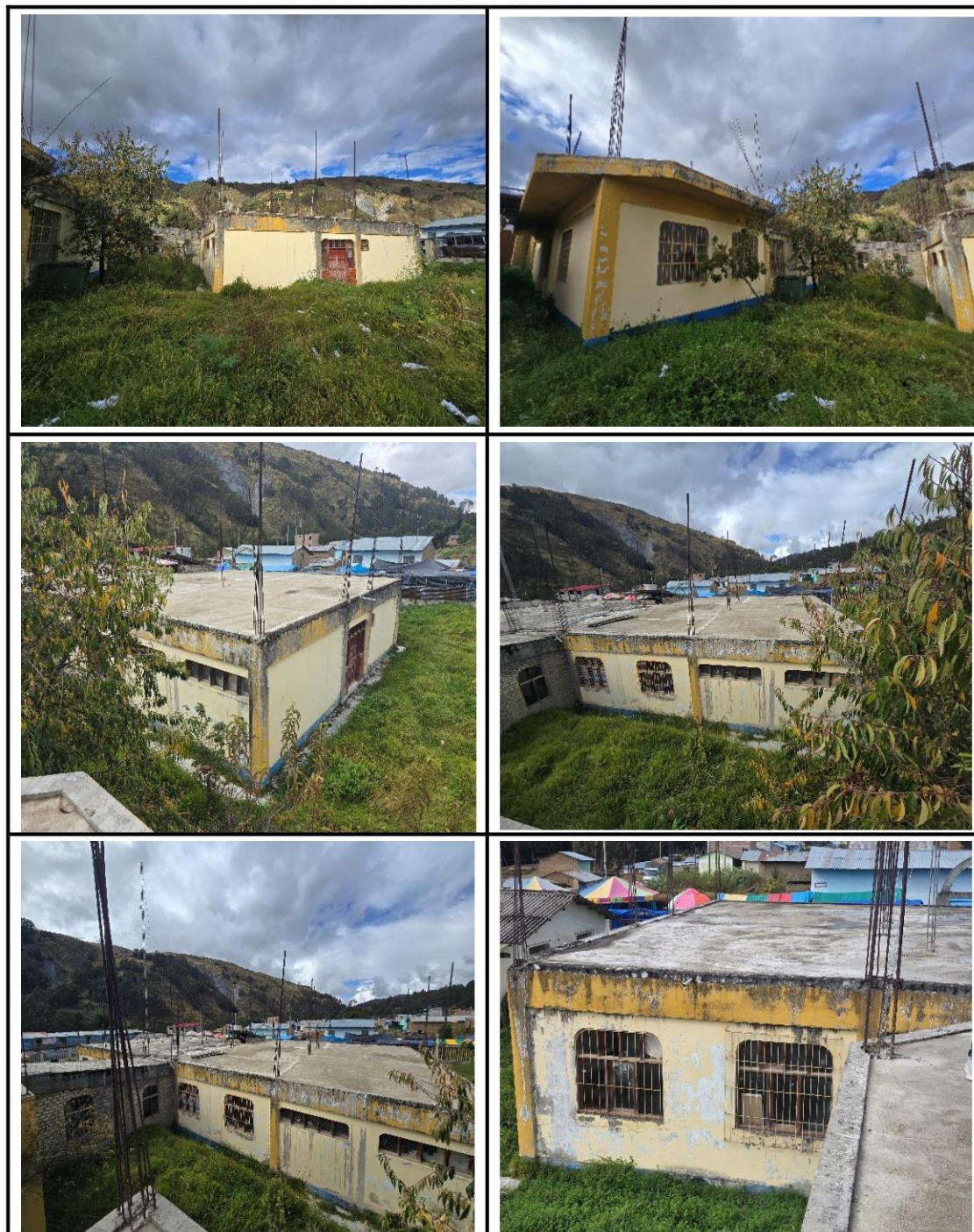
Imagen n.º 16, 17, 18, 19, 20 y 21 Deterioro de la fachada del Centro de Salud de Jesús
