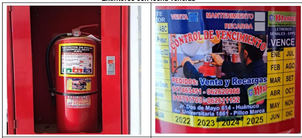
Imágenes n.º 34,35, 36 y 37 Extintores con fecha vencida
