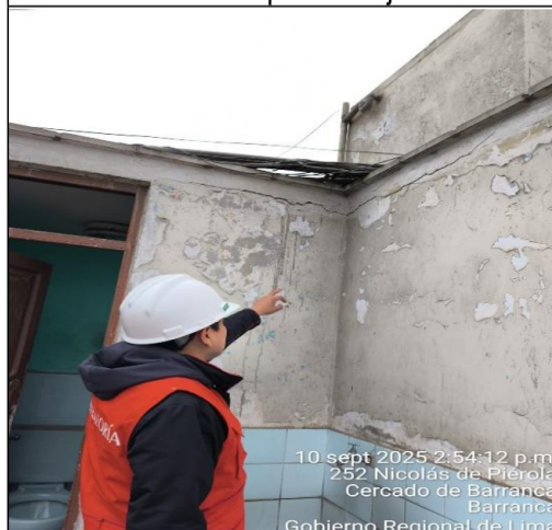
Paredes del baño del área de cómputo con rajaduras.
