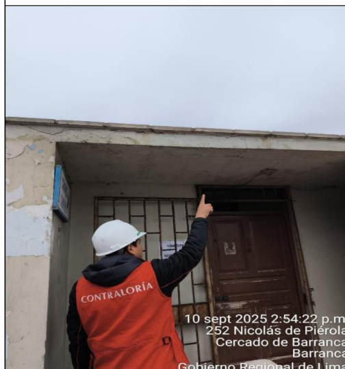
Techo del área de cómputo con rajaduras.
