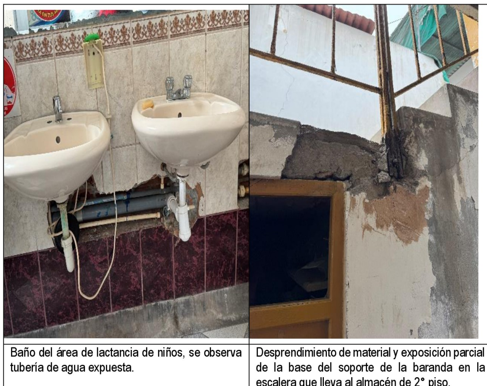
Imágenes n.ºs 1, 2, 3, 4, 5, 6, 7 y 8 Deficiencias en la infraestructura del Hospital Barranca – Cajatambo y SBS
