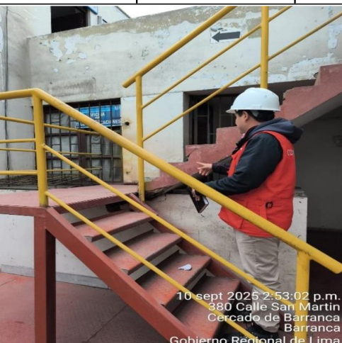
Escalera con rajaduras que lleva al tercer piso del área de Informática.
