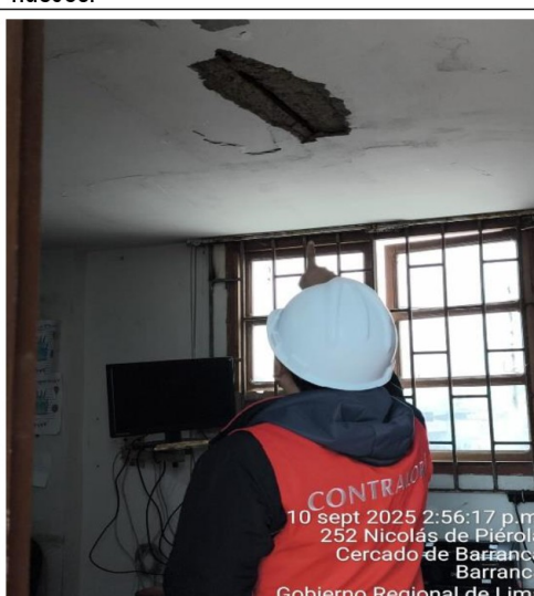
Fierro del techo expuesto en área de cómputo.
