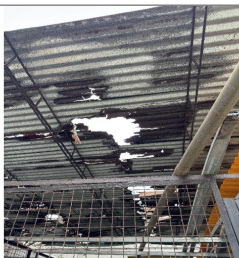
Techo de calamina que protege al generador con huecos.
