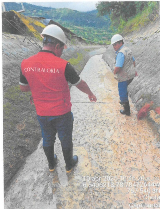
Imagen n.º 7 Fondo del canal del túnel de entrada n.º 3 erosionado
