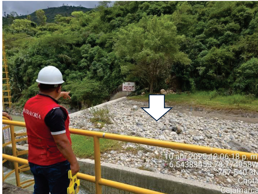
Imágenes n.ºs 12 y 13 Sedimento aguas arriba del barraje fijo en el río Chotano
