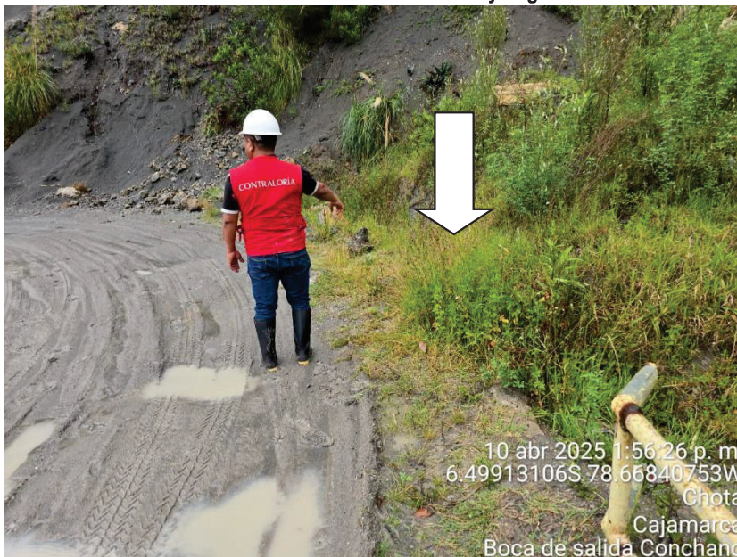
Cuneta con material de derrumbe y vegetación
