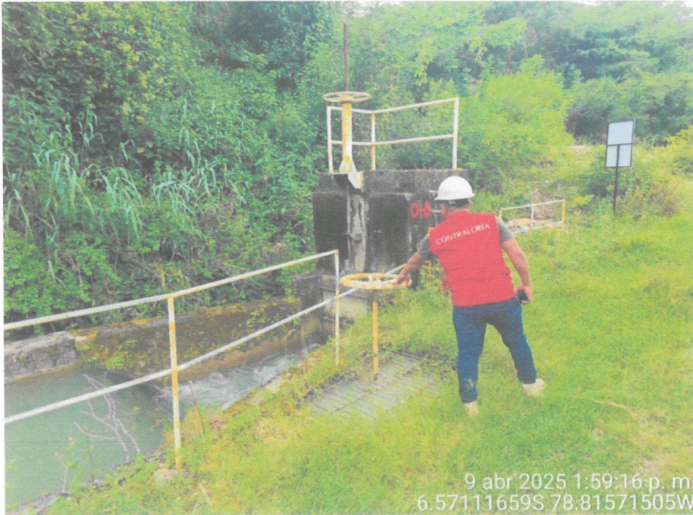
Imagen n.º 2 Falta de mantenimiento en las estructuras metálicas en el canal de derivación hacia la hidroeléctrica
