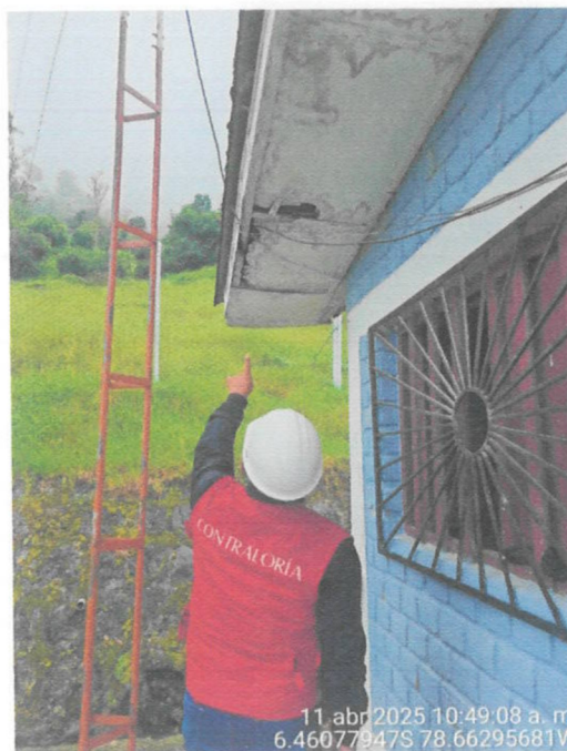
Imagen n.º25 Cielo raso de caseta del operador sin mantenimiento
