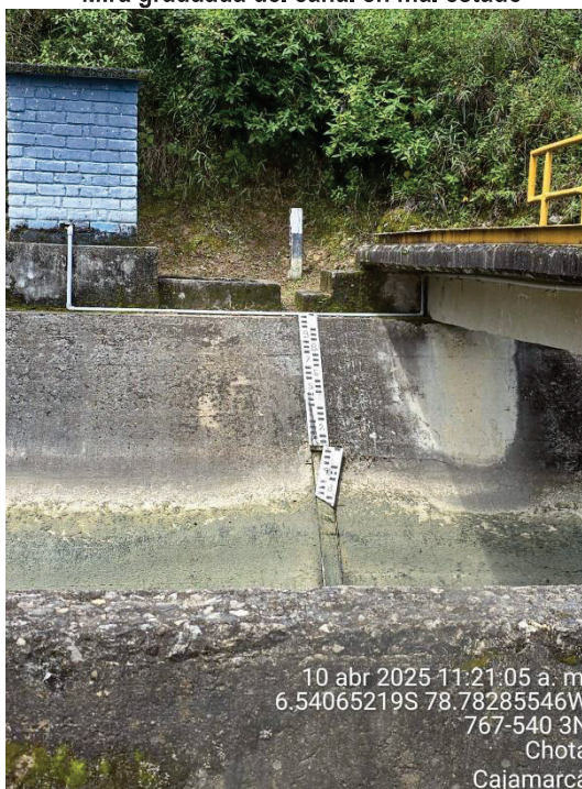
Imagen n.º22 Mira graduada del canal en mal estado
