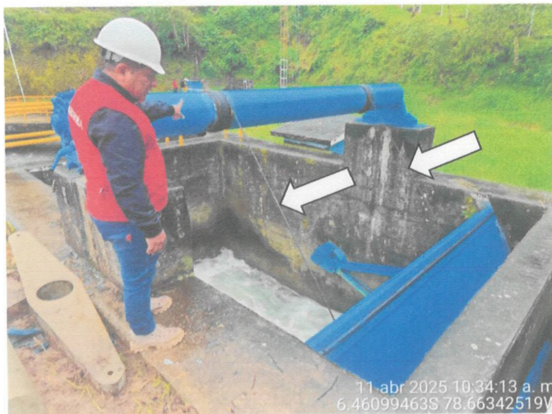
Imagen n.º24 Cables de compuerta radial sin mantenimiento y/o cambio
