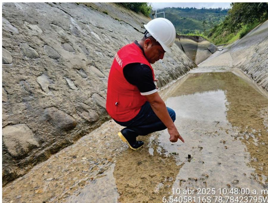
Imagen n.º 6 Erosión de 1" en el fondo del canal del túnel de entrada n.º 3
