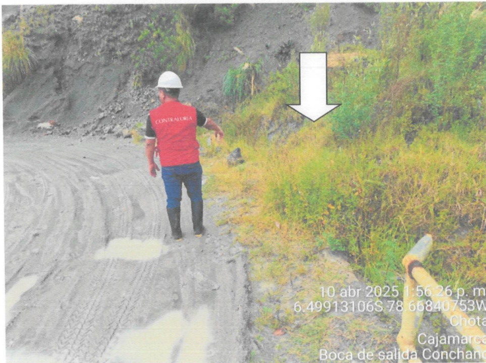
Imagen n.º23 Cuneta con material de derrumbe y vegetación
