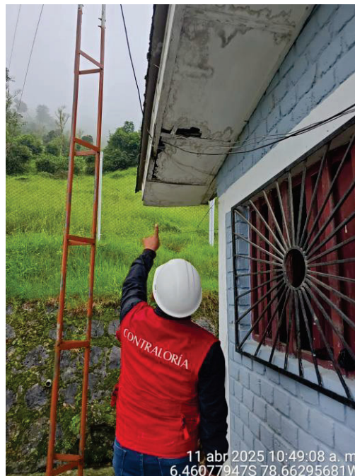
Imagen n.º28 Cielo raso de caseta del operador sin mantenimiento
