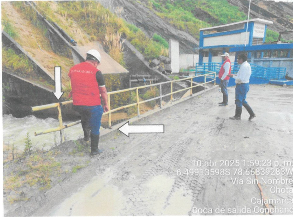
Imagen n.º22 Barandas de protección en mal estado
