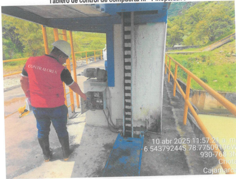
Imagen n.º 12 Tablero de control de compuerta n.º 1 inoperativo
