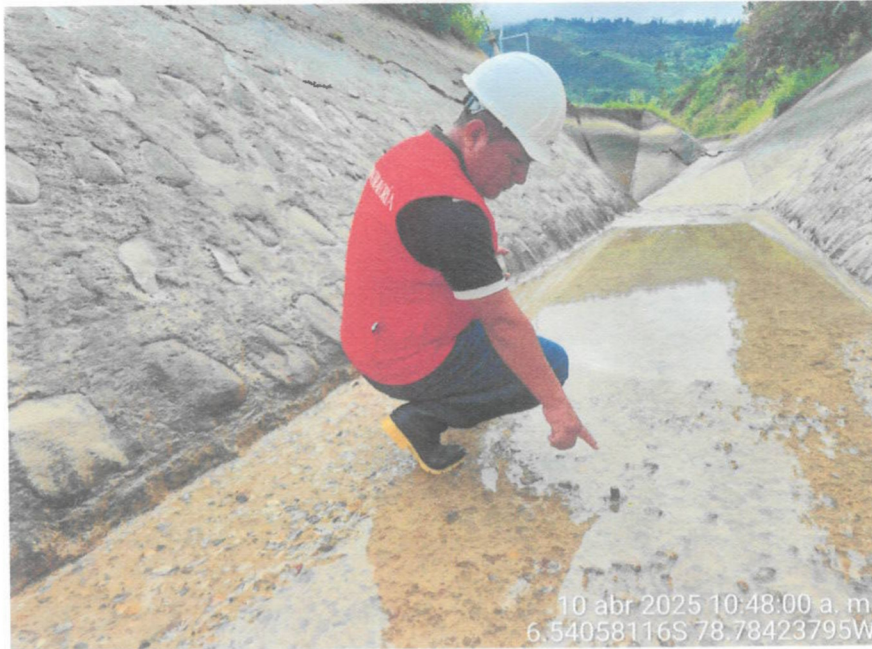
Imagen n.º 6 Erosión de 1" en el fondo del canal del túnel de entrada n.º 3
