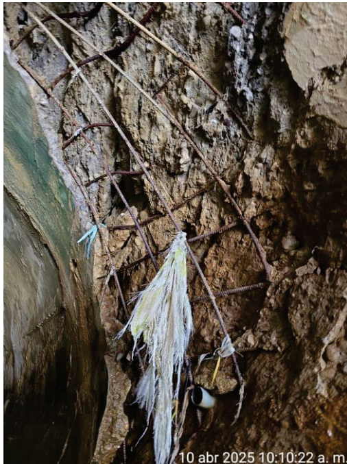
Imagen n.º 9 Acero expuesto al aire y humedad debido al deterioro del concreto
