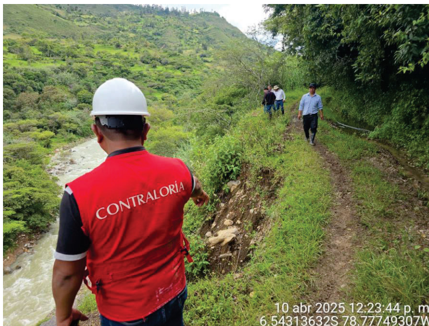
Imagen n.º 20 Erosiones que impiden el acceso a las estructuras de captación y derivación
