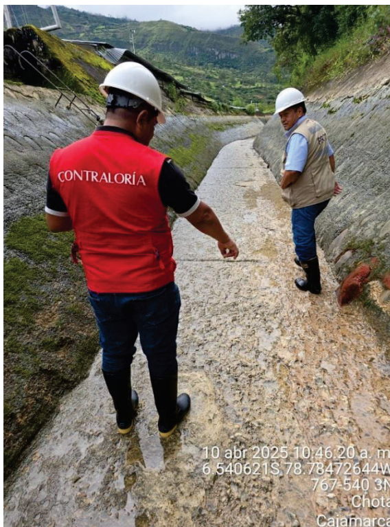
Imagen n.º 7 Fondo del canal del túnel de entrada n.º 3 erosionado
