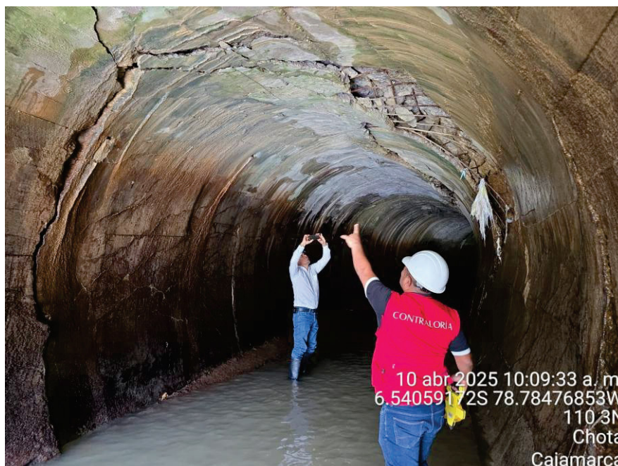
Imagen n.º 8 Deterioro del concreto en la parte superior del túnel n.º 3
