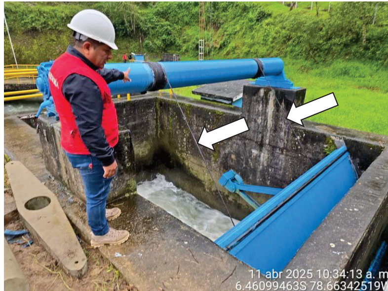
Imagen n.º27 Cables de compuerta radial sin mantenimiento y/o cambio
