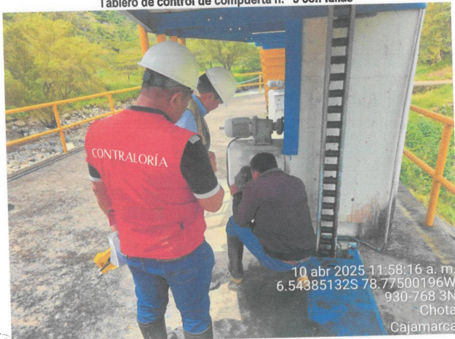
Imagen n.º 13 Tablero de control de compuerta n.º 3 con fallas
