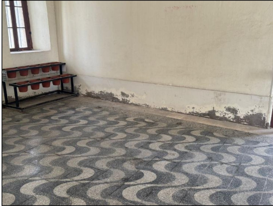
Imágenes N°s 19 y 20 Deterioro de pintura en el interior de la Capilla
