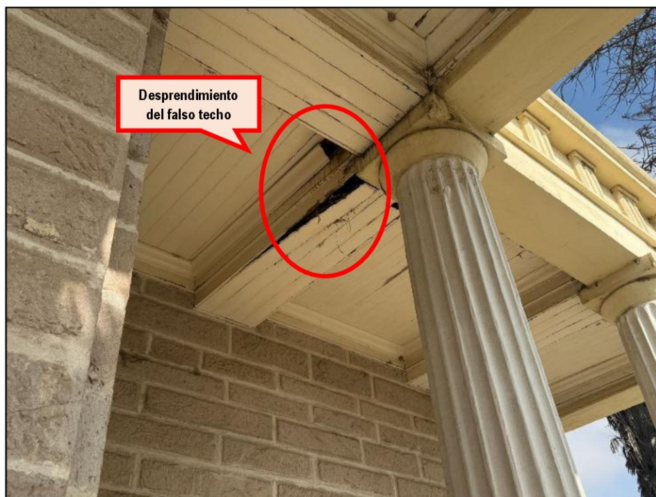
Imágenes Nos 17 y 18 Estado del falso techo exterior de la Capilla
