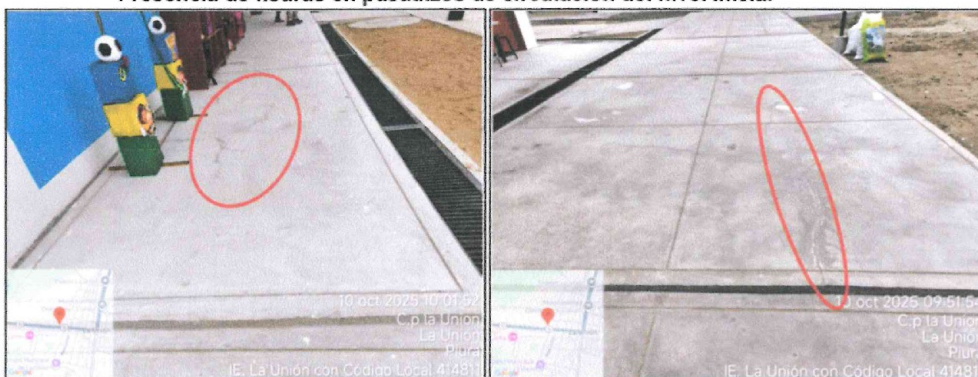
Imágenes n.° 2 y 3 Presencia de fisuras en pasadizos de circulación del nivel inicial
