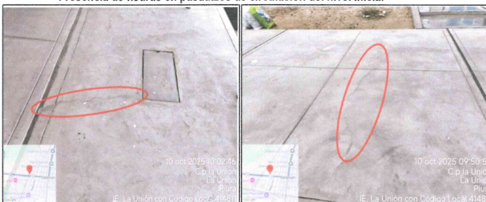
Imágenes n.° 4 y 5 Presencia de fisuras en pasadizos de circulación del nivel inicial
