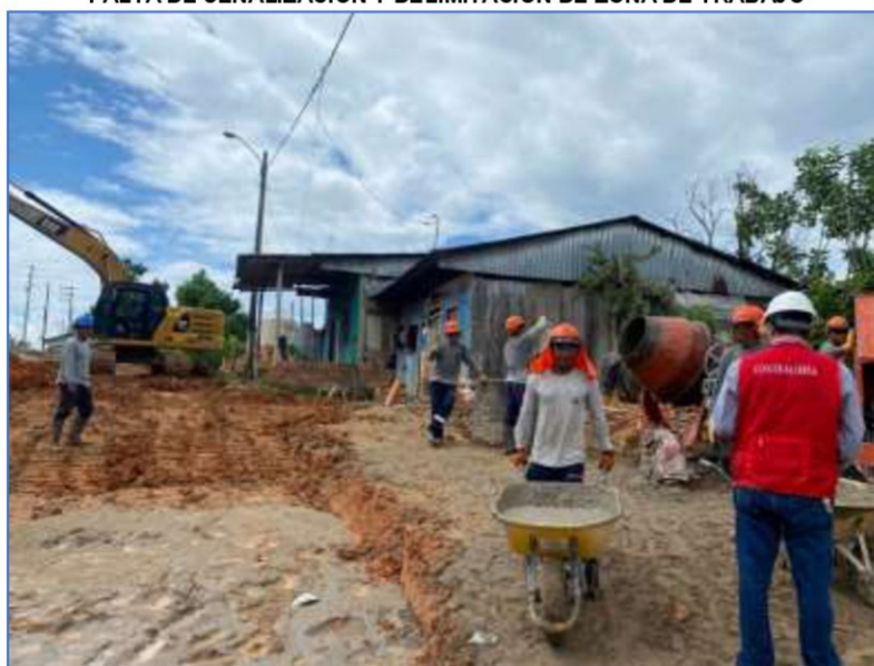
Imagen n.° 1 FALTA DE SEÑALIZACIÓN Y DELIMITACIÓN DE ZONA DE TRABAJO
