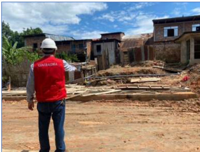
Imagen n.º 4 FALTA DE DELIMITACIÓN CON MALLA DE SEGURIDAD
