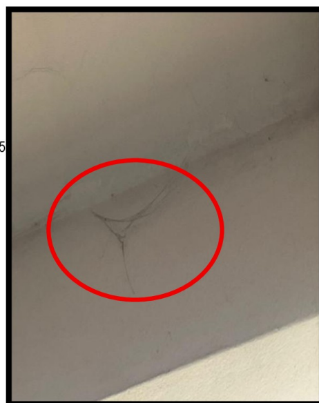
Presencia de telarañas
