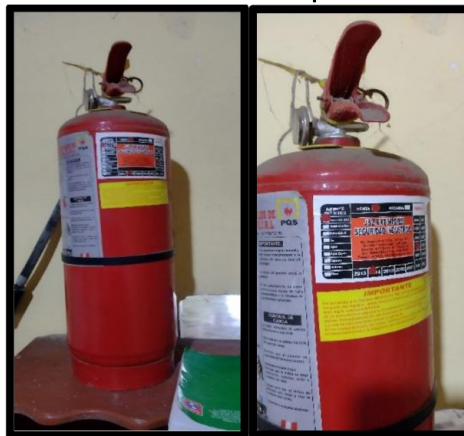
Extintor vencido e inoperativo
