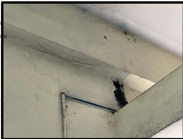
Presencia de telarañas
