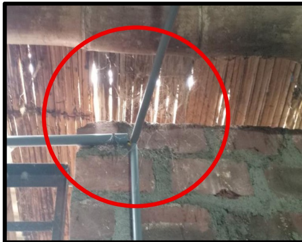
Presencia de telarañas
