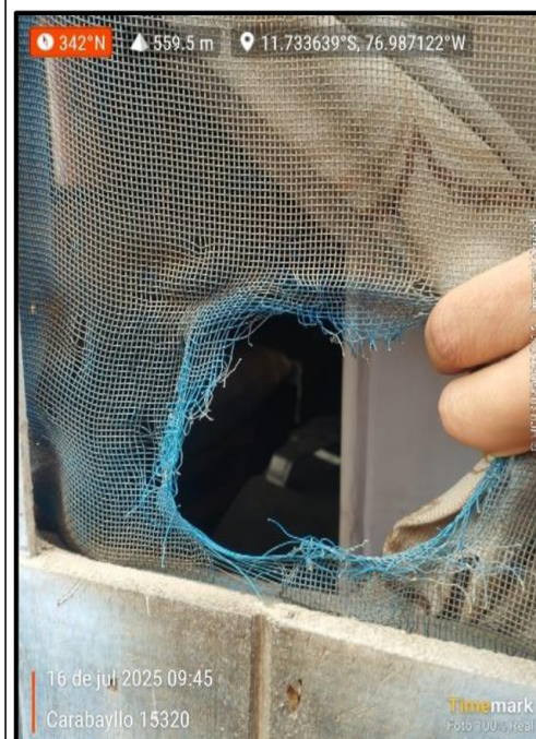
Comedor “Flor de Magnolias” C.P. Virgen del Carmen (Distrito de Santa Rosa de Quives), se observó que, las ventanas del almacén tienen la malla rota, lo cual propicia el ingreso de roedores e insectos.
