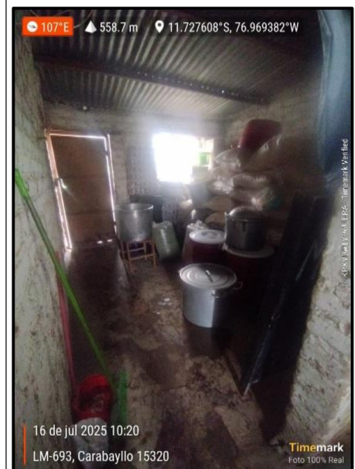
Comedor “Santa Catalina” Anexo Trapiche Bajo (Distrito de Santa Rosa de Quives), se observó que, la puerta de trasera del almacén se encuentra en mal estado, lo cual propicia el ingreso de roedores e insectos.
