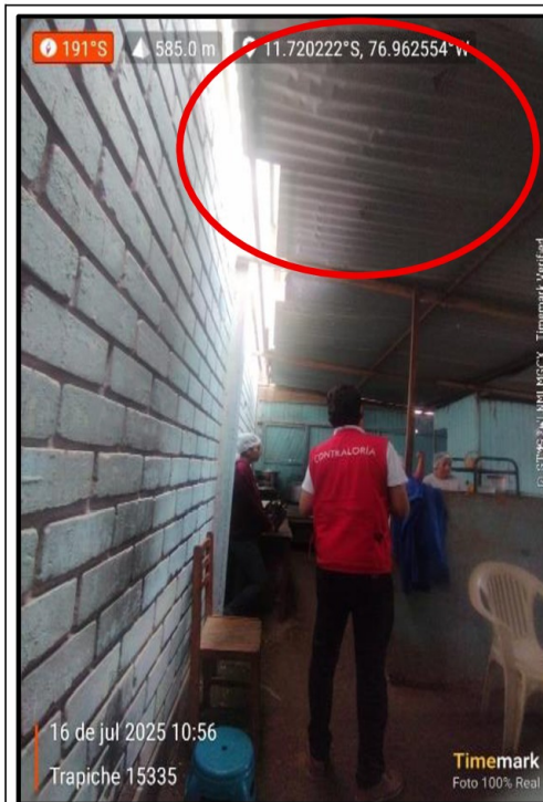
Comedor “San Antonio de Padua”, anexo Trapiche Alto (Distrito de Santa Rosa de Quives), se observó el techo de calima deficiente
