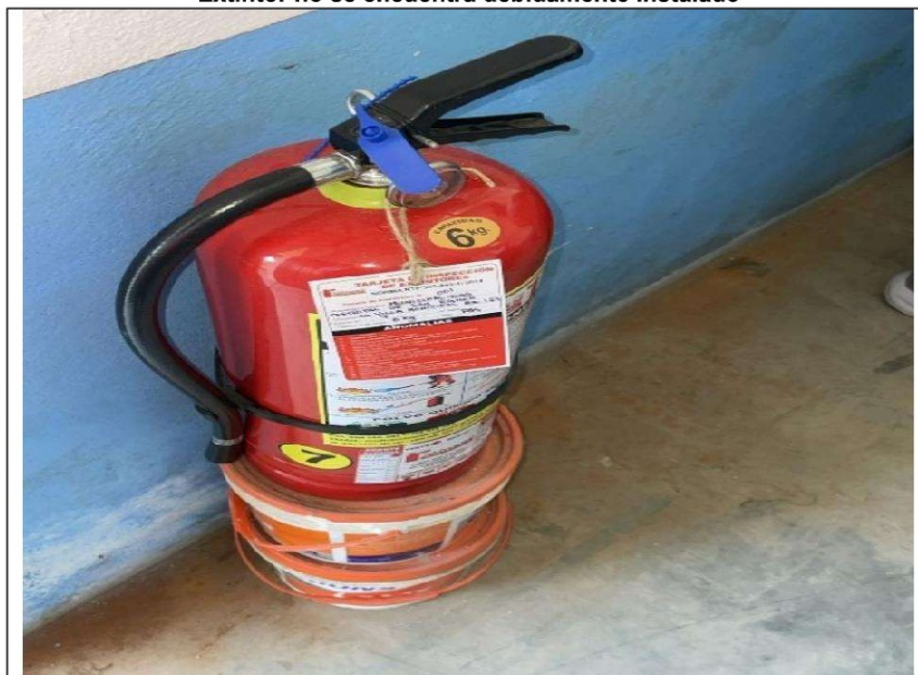
Imagen n.º 7 Extintor no se encuentra debidamente instalado
