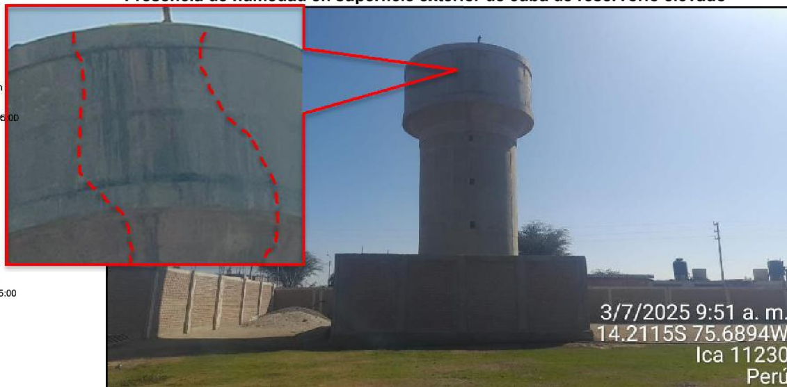
Imagen n.º 2 Presencia de humedad en superficie exterior de cuba de reservorio elevado
