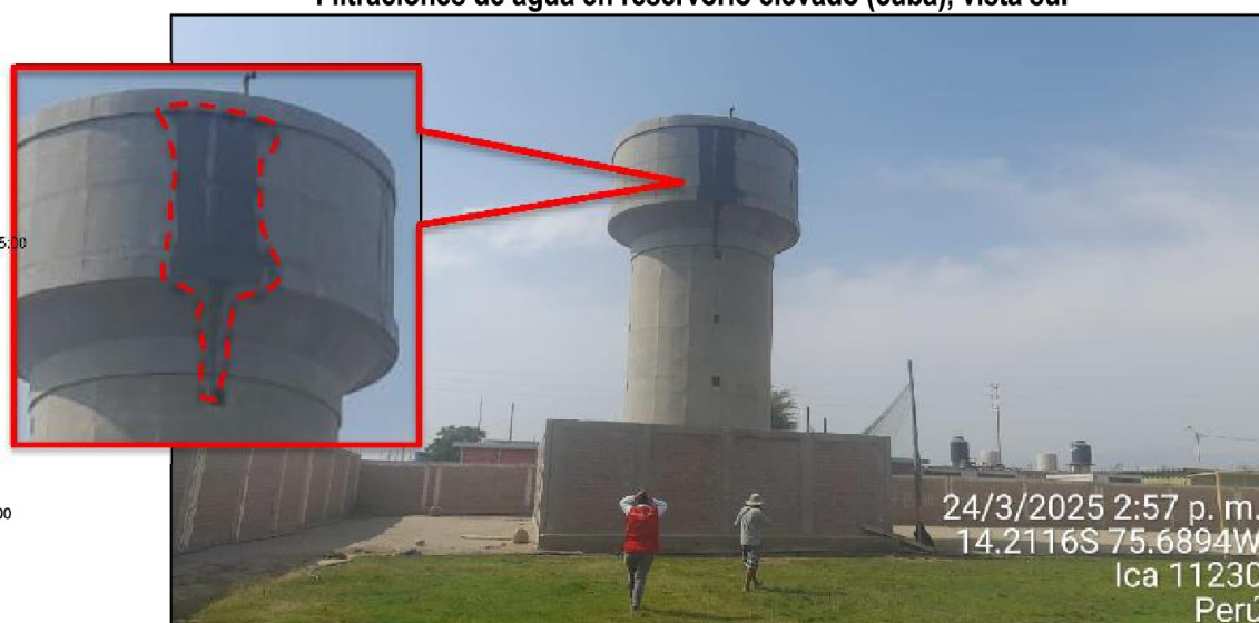
Imagen n.º 6 Filtraciones de agua en reservorio elevado (cuba), vista sur
