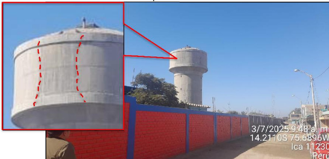
Imagen n.º 1 Presencia de humedad en superficie exterior de cuba de reservorio elevado
