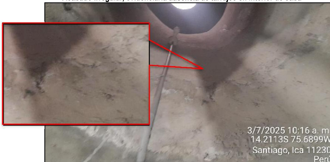
Imagen n.º 5 Acabado irregular, evidenciaría ausencia de tarrajeo en interior de cuba
