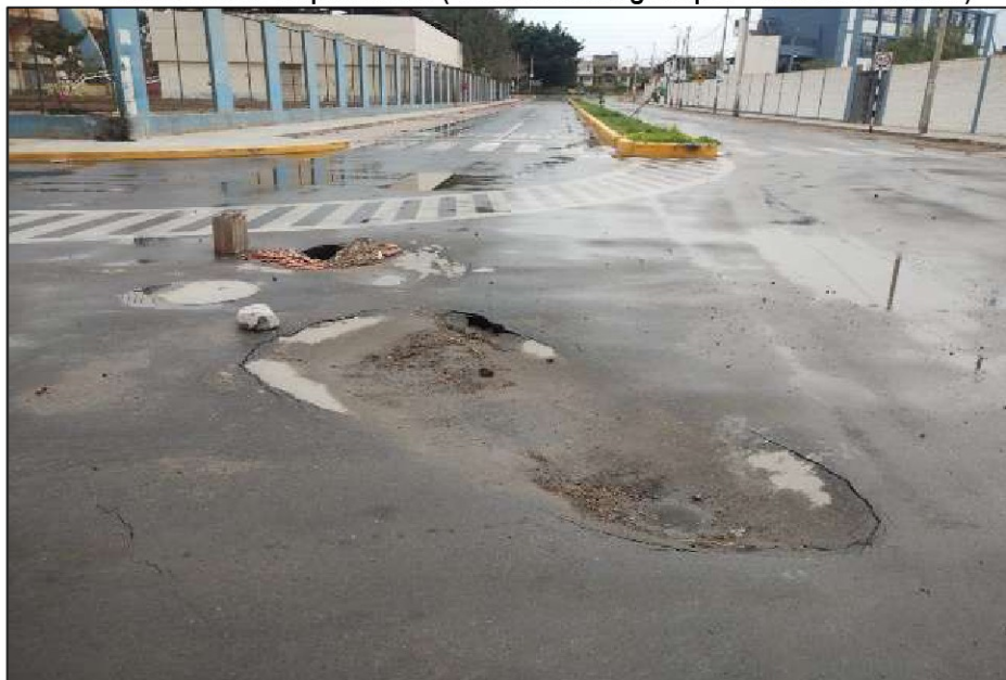
Imagen N° 21 Hundimiento de pavimento (Evidencia entregada por morador de la zona)
