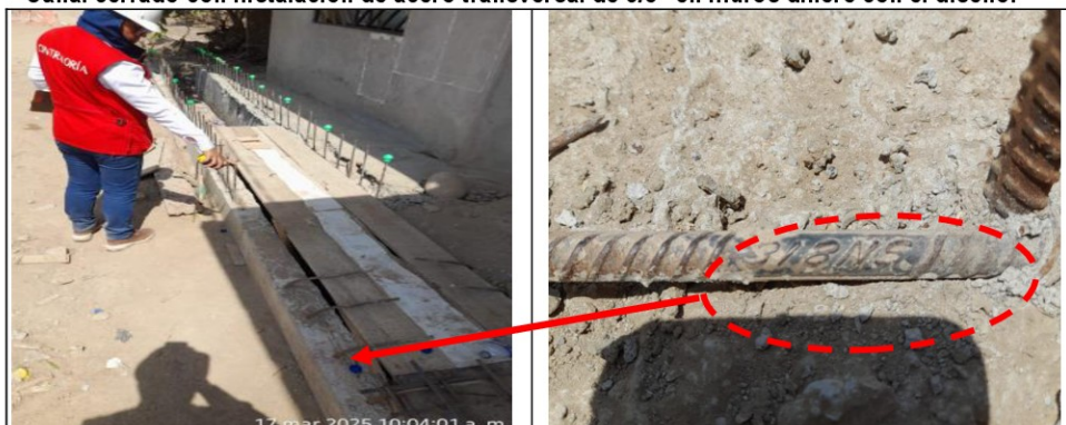
Imagen n.º 47 Canal cerrado con instalación de acero transversal de 3/8" en muros difiere con el diseño.
