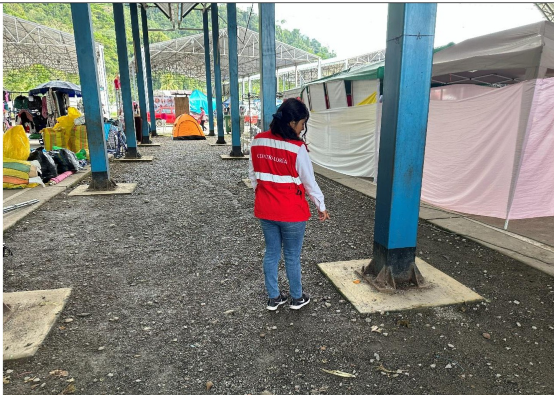
Base metálica de la columna cuadrada, los pernos de anclaje y la parte inferior de la columna en estado de corrosión, en la cobertura metálica 3
