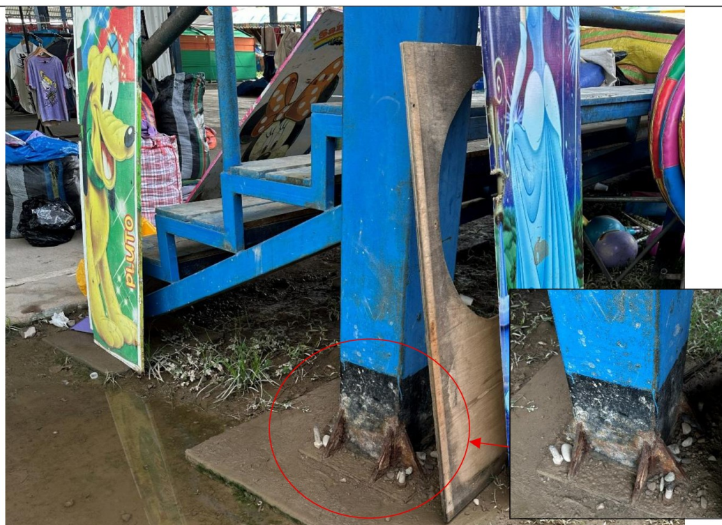
Base metálica de la columna cuadrada, y parte inferior de la columna en estado de corrosión, en la cobertura metálica 4
