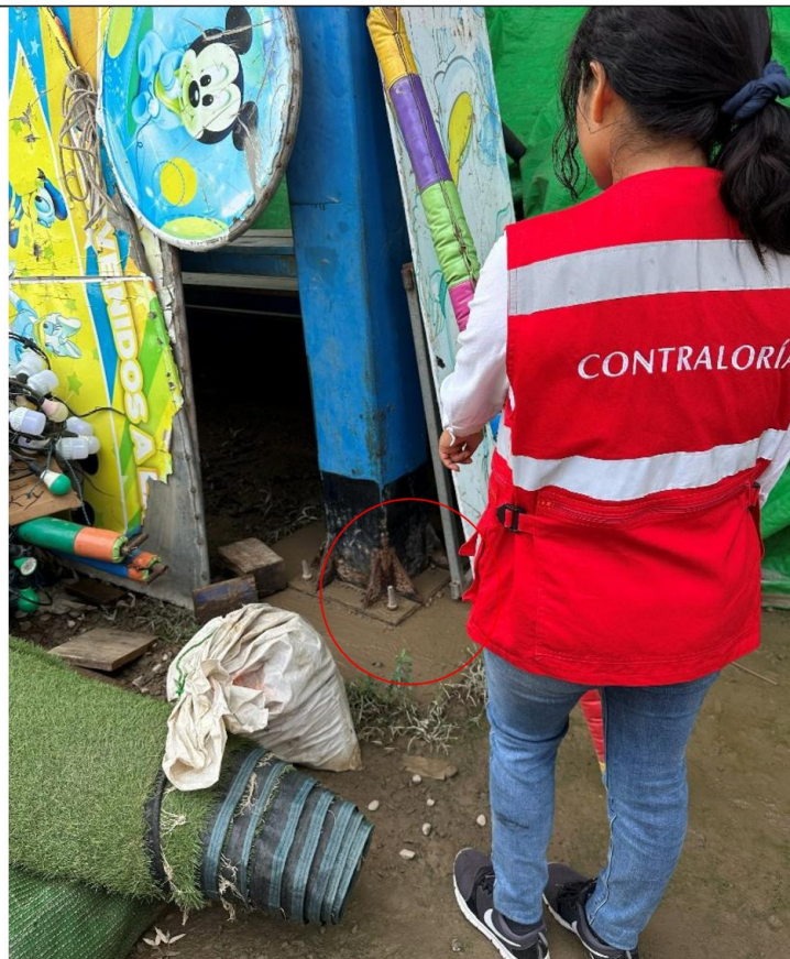
Base metálica de la columna cuadrada, y parte inferior de la columna en estado de corrosión, en la cobertura metálica 4
