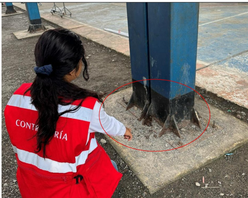
Base metálica de la columna cuadrada, los pernos de anclaje y la parte inferior de la columna en estado de corrosión en la cobertura metálica 1
