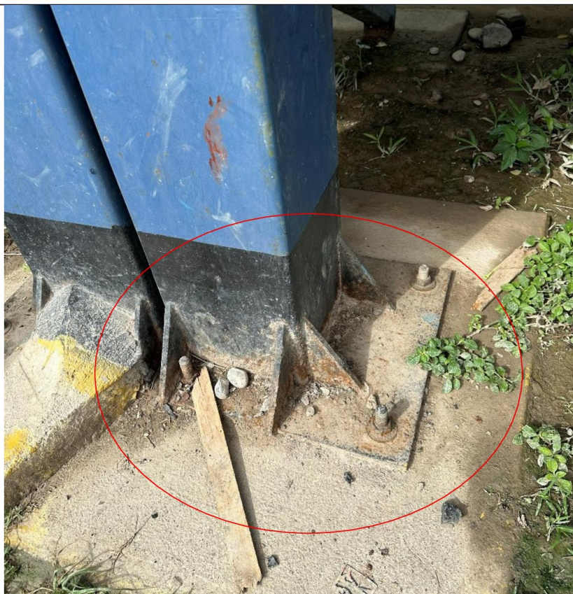
Base metálica de la columna cuadrada, los pernos de anclaje y la parte inferior de la columna en estado de corrosión, en la cobertura metálica 1
