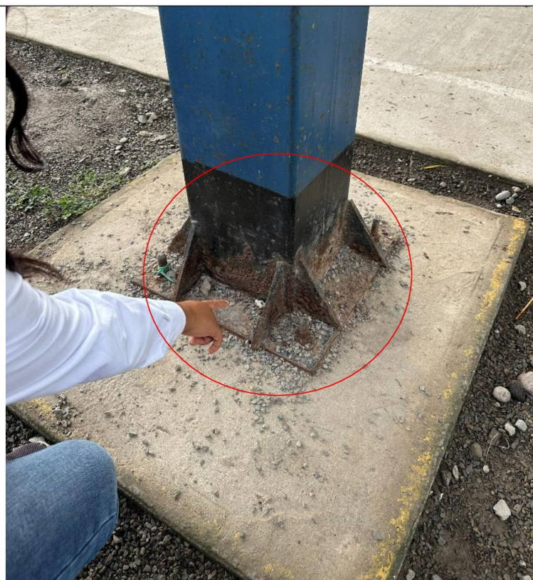
Base metálica de la columna cuadrada, los pernos de anclaje y la parte inferior de la columna en estado de corrosión en la cobertura metálica 1
