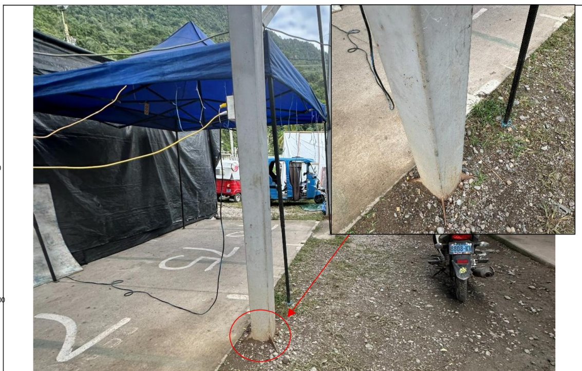
Base metálica de la columna cuadrada, y parte inferior de la columna en estado de corrosión en área destinada a comercio y venta de comidas
