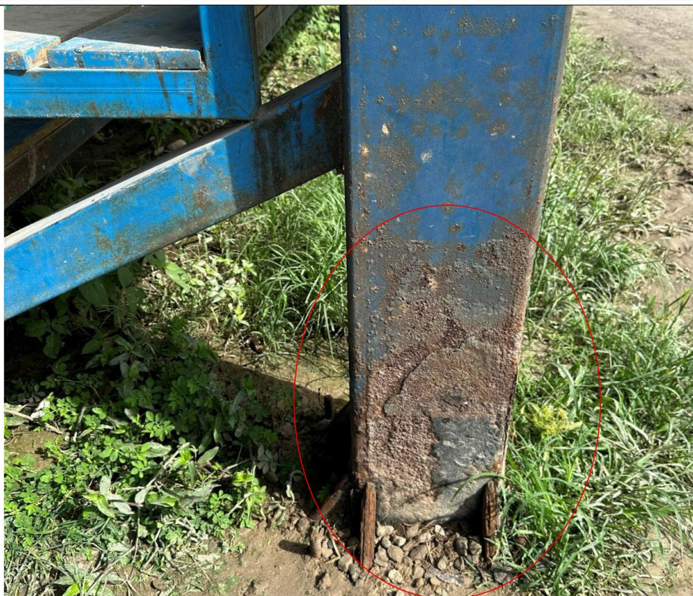
Base metálica de la columna cuadrada, los pernos de anclaje y la parte inferior de la columna, en estado de corrosión en la cobertura metálica 1
