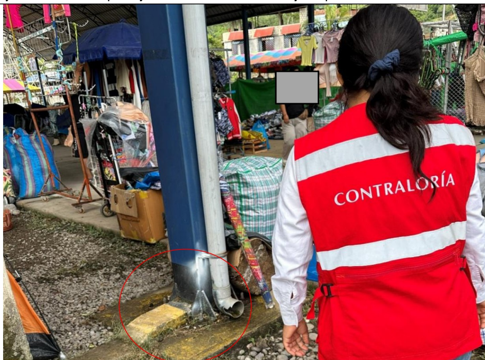
Base metálica de la columna cuadrada, y parte inferior de la columna en estado de corrosión, y tubería de PVC que baja de las canaletas de drenaje de pluvial de la cobertura metálica 4
