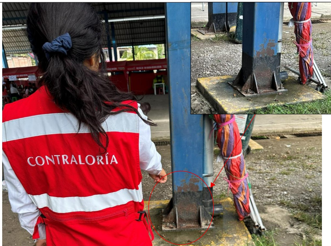
Base metálica de la columna cuadrada, los pernos de anclaje y la parte inferior de la columna en estado de corrosión y tubería de PVC que baja de las canaletas de drenaje de pluvial de la cobertura metálica 2
