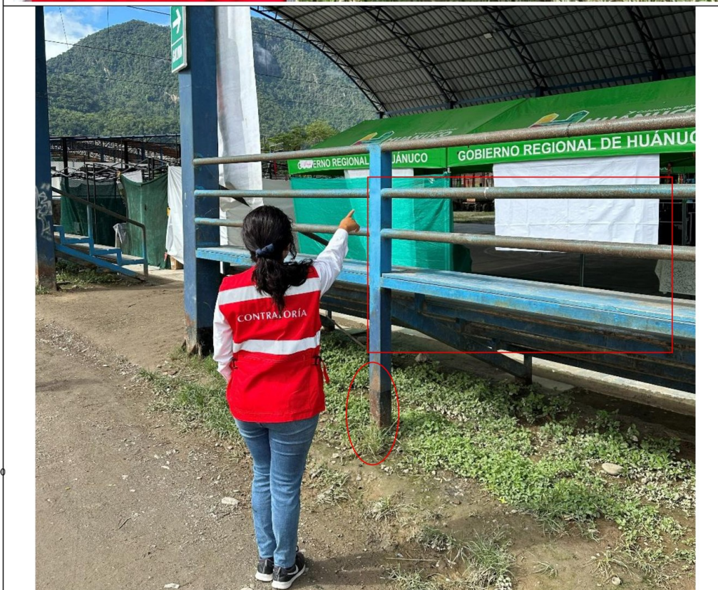
Baranda circular metálica de tribuna en estado de corrosión y deterioro de columna que se encuentra sin apoyo con el suelo, debajo de la cobertura 1
