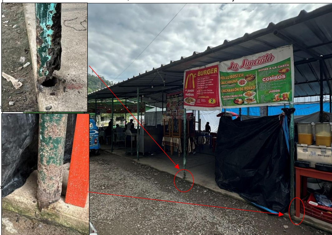
Parte inferior de las columnas metálicas en estado de corrosión, una de la columna se encuentra parcialmente apoyada en el suelo, en área destinada a venta de comida
