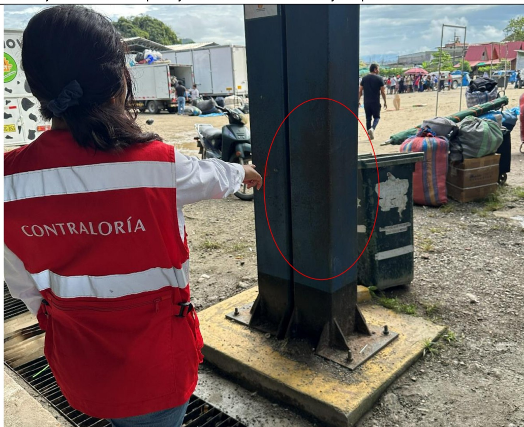
Columna metálica cuadrada en estado de corrosión, en la cobertura metálica 3
