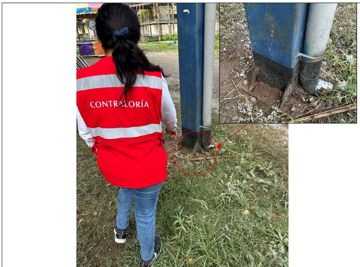
Base metálica de la columna cuadrada, los pernos de anclaje y la parte inferior de la columna en estado de corrosión, y tubería de PVC que baja de las canaletas de drenaje de pluvial, en la cobertura metálica 4
