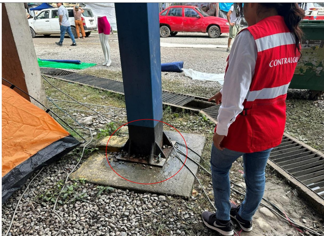
Base metálica de la columna cuadrada, los pernos de anclaje y la parte inferior de la columna en estado de corrosión, en la cobertura metálica 4.
