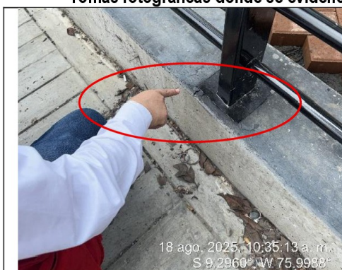
Fisura en sardinel de concreto
