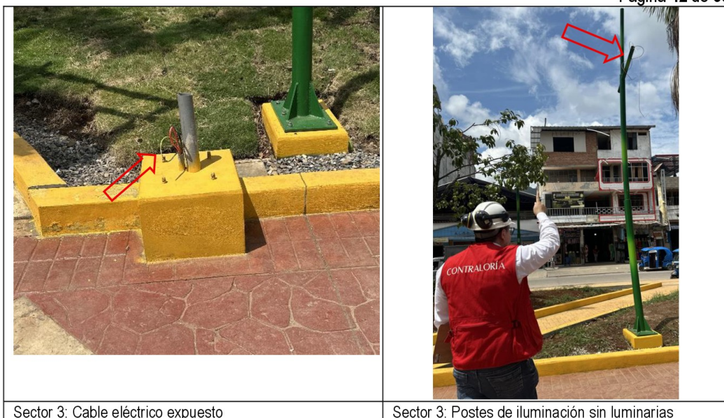
Sector 3: Cable eléctrico expuesto
