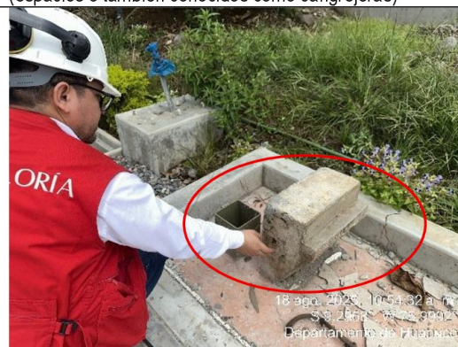
Segregación del agregado de mezcla de concreto (espacios o también conocidos como cangrejeras)
