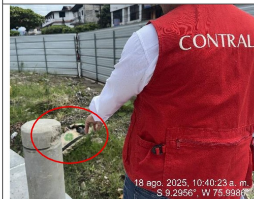
Bolardo tipo I dañado
