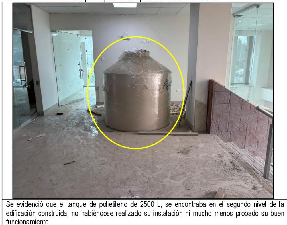
Vista fotográfica n.º 6 Tanque de polietileno que no había sido instalado
