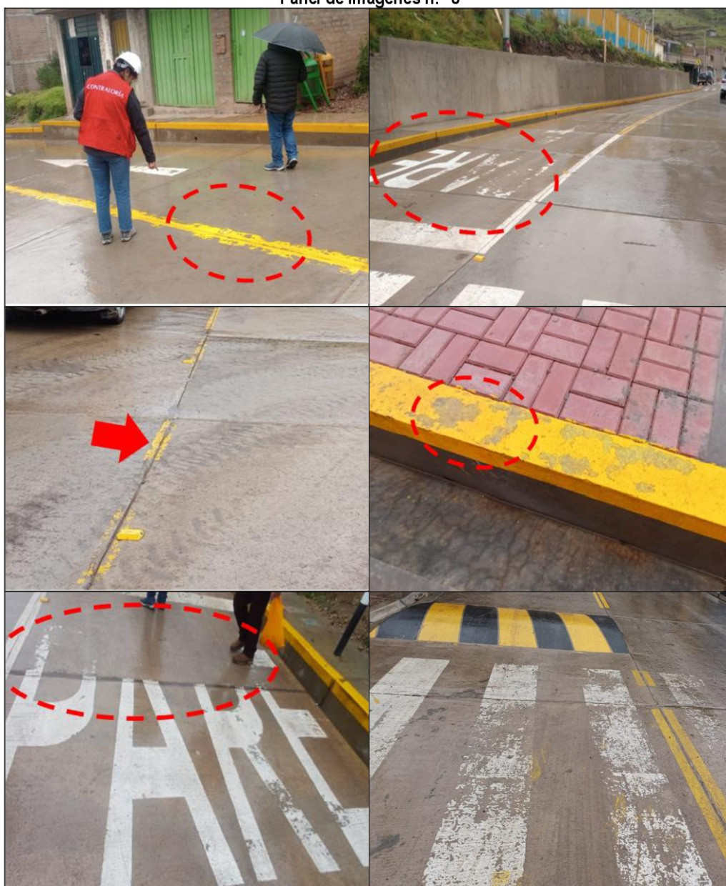
Imágenes del 25 al 30: Pintura en pavimento y sardineles con desgaste prematuro.
