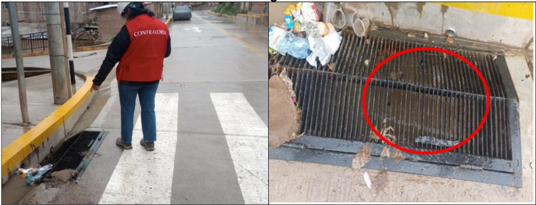
Imágenes n.ºs 39 y 40: Caja ubicado en la progresiva 0+285 se encuentra colmatado y obstruido, asimismo, en su interior presenta material de encofrado.
