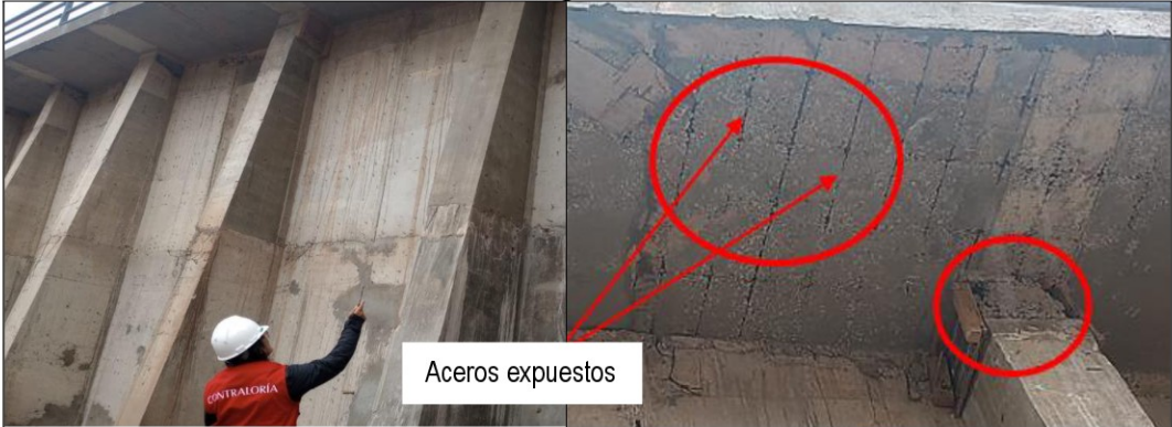
Imágenes n.ºs 43 y 44: Acero expuesto en veredas, asimismo se evidencia la segregación de la corona de contrafuerte y veredas.
