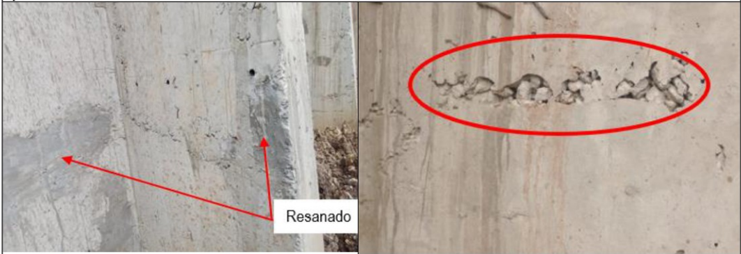
Imagen n.º 45: Se evidencia parte del muro y contrafuerte con resane.
