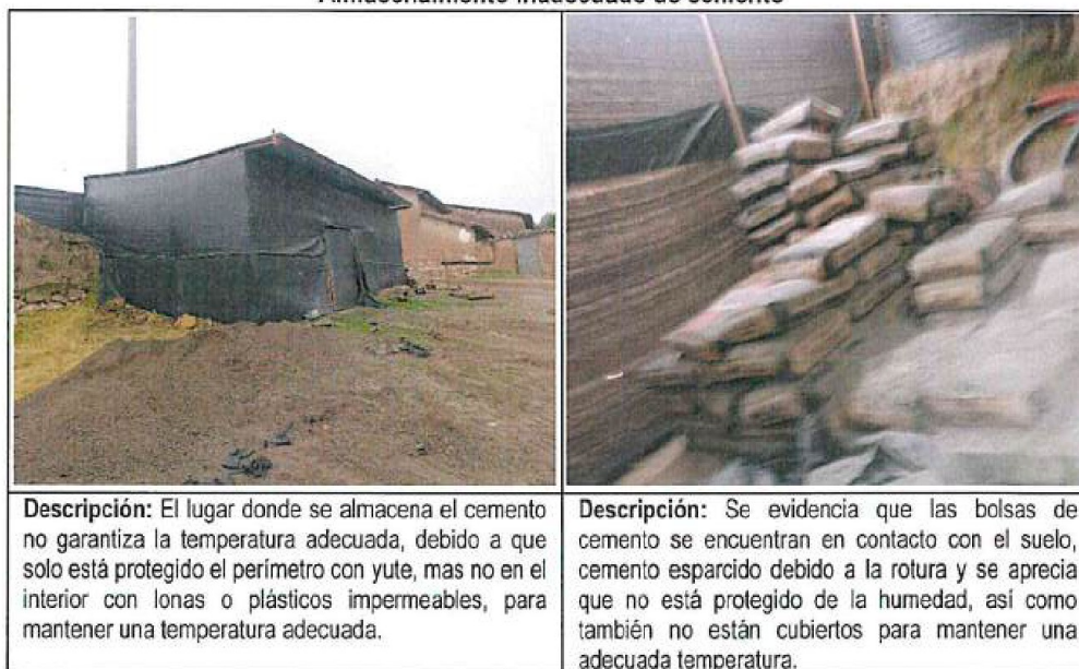
Fotografías n.ºs 29 y 30 Almacenamiento inadecuado de cemento
