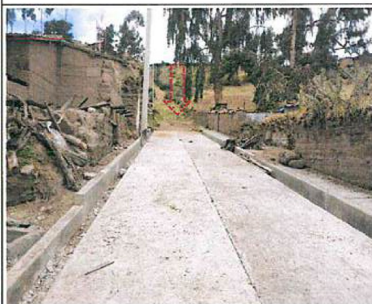
Descripción: Calle Progreso C1, sin señalización ni tranquera adecuado que restrinja el paso de transeúntes.
