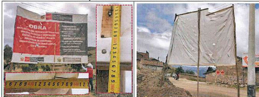
Fotografías n.ºs 63 y 64 Deficiente ejecución de cartel de identificación de obra
