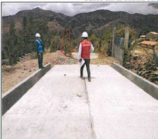
Descripción: Calle Amargura C1, sin señalización ni tranquera adecuado que restrinja el paso de transeúntes.
