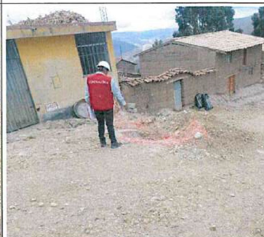
Descripción: Deficiente señalización de Buzón en la Calle Hipólito Unanue C1.
