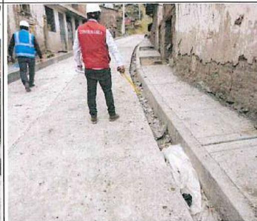
Descripción: Calle Progreso C1, sin señalización.
