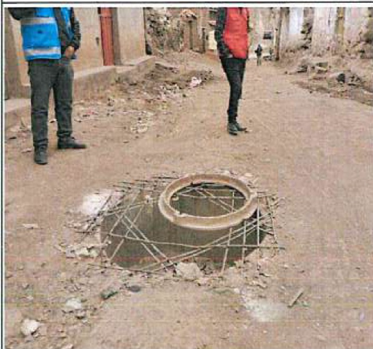
Descripción: Buzón existente sin la debida protección y señalización en el Calle Mariscal Cáceres C2.
