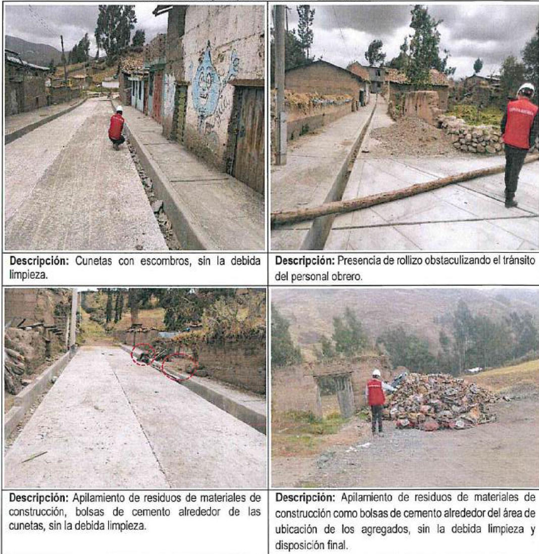
Fotografías n.ºs 25,26,27, y 28 Falta de orden y limpieza de residuos en la obra
