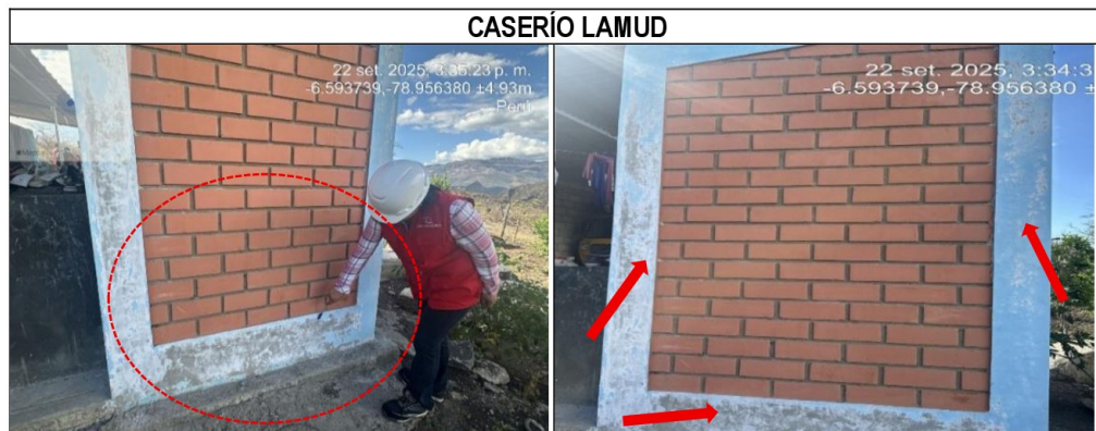
Fotografías N°s 01 y 02: Se evidencia presencia de humedad en los muros de la caseta de la unidad básica de saneamiento (UBS) N° 010 ubicado en el Caserío Lamud, asimismo, se aprecia que la pintura presenta descascaramiento y pérdida de la misma.
