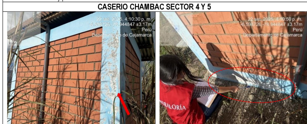
Fotografías N°s 03 y 04: Se evidencia presencia de humedad en los muros de la unidad básica de saneamiento (UBS) N° 077, asimismo, se aprecia que la pintura presenta descascaramiento y pérdida de la misma.
