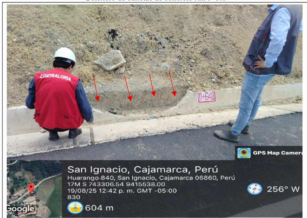
Fotografía n.º 6 Deterioro de cunetas de concreto Km 0+640
