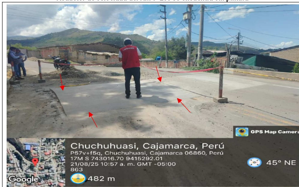
Fotografía n.º 8 Reductor de velocidad del Km 0+235 se encuentra sin pintura
