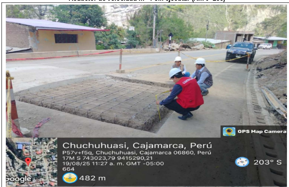
Fotografía n.º 2 Reductor de velocidad n.º 1 sin ejecutar (Km 0+235)
