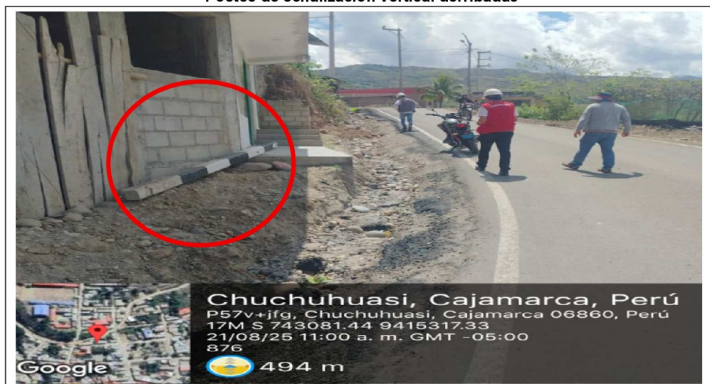
Fotografía n.º 9 Postes de señalización vertical derribadas
