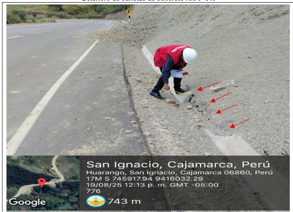
Fotografía n.º 7 Deterioro de cunetas de concreto Km 0+640
