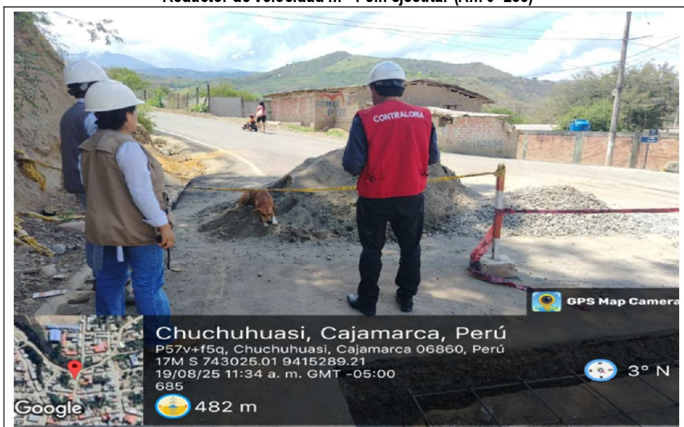
Fotografía n.º 3 Reductor de velocidad n.º 1 sin ejecutar (Km 0+235)
