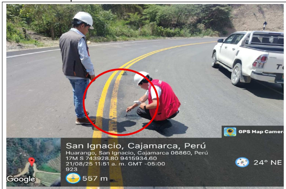
Fotografía n.º 11 Deterioro del empalme entre ambos carriles de la vía entre el km 1+960 al Km 1+980
