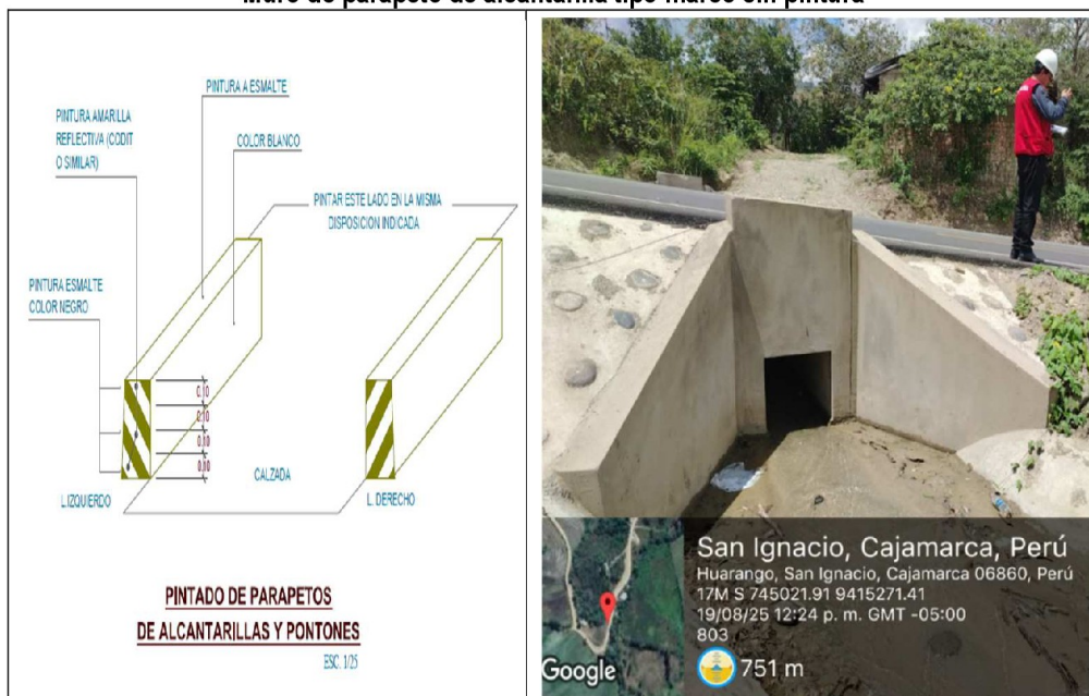
Fotografía n.º 10 Muro de parapeto de alcantarilla tipo marco sin pintura
