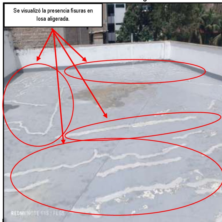
Imagen n.º 2 Presencia de fisuras en losa aligerada
