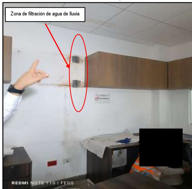
Imagen n.º 11 Presencia de filtración de agua de lluvia
