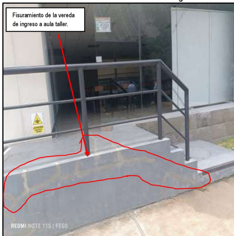
Imagen n.º 10 Presencia de fisuramiento en vereda de ingreso
