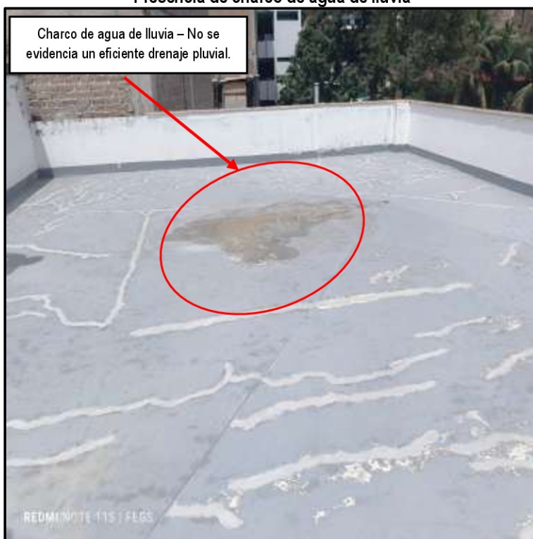
Imagen n.º 9 Presencia de charco de agua de lluvia
