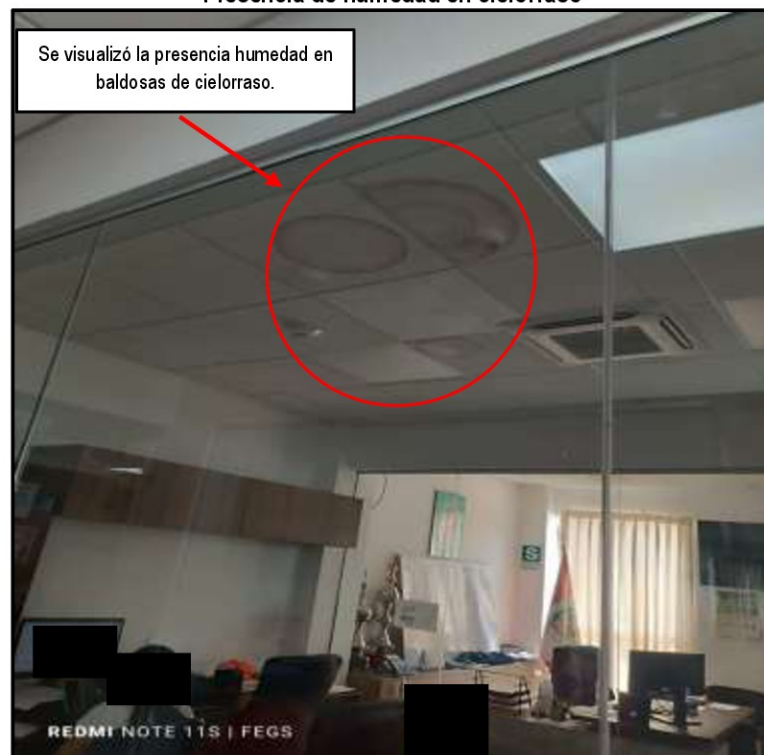
Imagen n.º 5 Presencia de humedad en cielorraso
