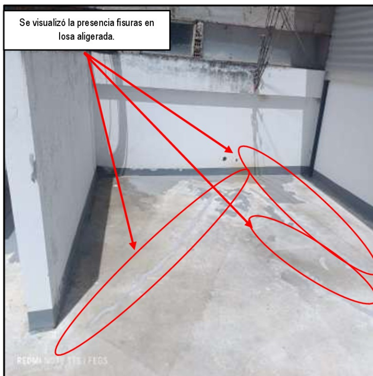
Imagen n.º 3 Presencia de fisuras en losa aligerada
