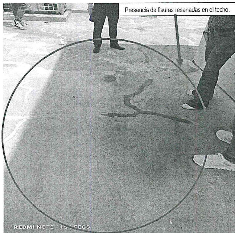
Imagen n.º 3 Fisuras resanadas en el techo de la infraestructura
