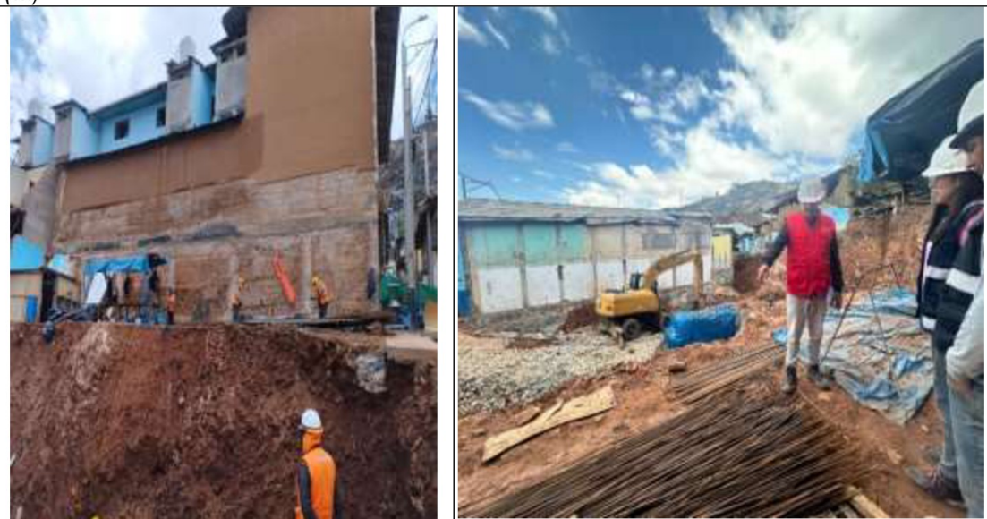
Fotografías N°s 11 y 12: Se observa la instalación de un taller para los trabajos de corte y doblado de fierro, asimismo, se aprecia la exposición del taller por posibles deslizamientos por la excavación del terreno, el cual no cuenta con protección ni señalización perimetral.
