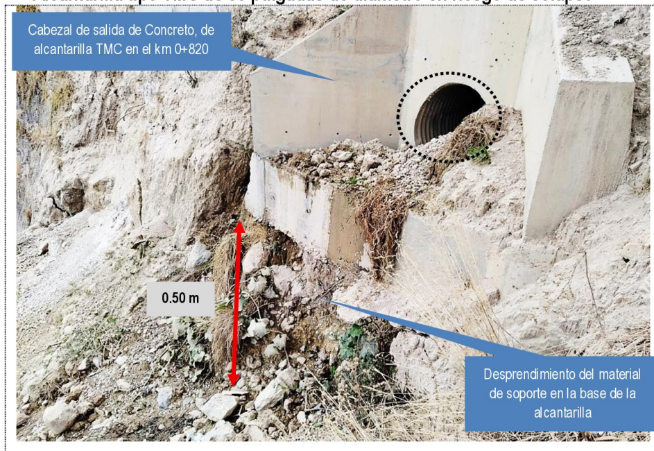
Fotografía n.º 1 Alcantarilla tipo TMC de 36 pulgadas de diámetro en riesgo de colapso
