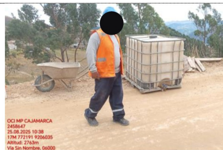
Fotografía N° 1: Vista de un obrero realizando trabajos de encofrado y desencofrado de las cunetas triangulares en la progresiva Km 3+680, sin guantes de protección y lentes.
